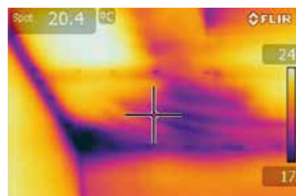
Fot. 7. Termogram. Poddasze ocieplone: przy murłacie, na krokwi i łacie oraz przy ścianie szczytowej widoczne „łączące języki zimna” na paroizolacji – nieszczelności, brak wełny w narożu
