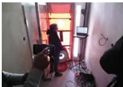
Fot. 18. Badanie szczelności budynku poddanego kompleksowej renowacji do standardu EnerPHit. Termogram obrazuje właściwą jakość termiczną na ścianie zewnętrznej i drzwiach przedsionka. Stwierdzono brak ucieczki ciepła w zewnętrznych przegrodach budowlanych. Test szczelności: w chwili badania pomiar wynosił n50 = 0,32 \text{ h1} , czyli prawie o 50% mniej niż wymagane n50 \leq 0,6 \text{ h1}
