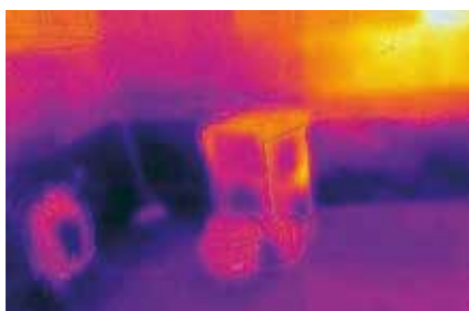
Fot. 3. W badaniach in situ widoczne zalanie do ok. 40 cm, osuszanie na początkowym etapie i termogram obrazujący rzeczywiste nasączenie muru wodą do ok. 80 cm oraz wtórne jej podciąganie powyżej, znacznie nasilone w narożniku
