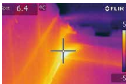
Fot. 8. Termogram. Poddasze nieocieplone: przy murłacie i przy ścianie szczytowej widoczna ucieczka ciepła z poddasza ocieplonego przez naroże. Połacie dachu nieocieplone: przy murłacie i na ścianie – nieszczelności termiczne międzykondygnacyjne
