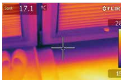
Fot. 13. Widoczne próg drzwi balkonowych i rama drzwiowa. Termogram pokazuje rzeczywisty napływ zimna do pomieszczenia (różnica temperatury 13K). Zły montaż stolarki drzwiowej lub brak regulacji
