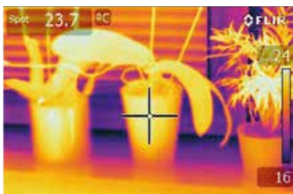
Fot. 12. Widoczne kwiatki na parapecie, w temperaturze pokoju. Termogram obrazuje napływ zimna do pomieszczenia (różnica temperatury 8K). Zły montaż stolarki okiennej lub brak regulacji
