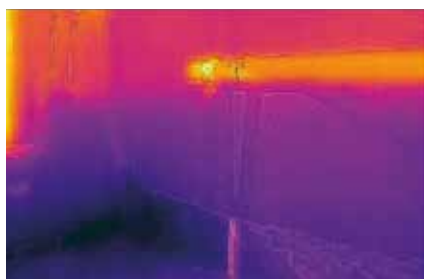
Fot. 2. W badaniach in situ nie stwierdzono zacieków na tynku po zalaniach. Termogram obrazuje rzeczywiste nasączenie muru wodą do ok. 100 cm i wtórne jej podciąganie powyżej, a także znaczące nasilenie wody w narożniku ścian
