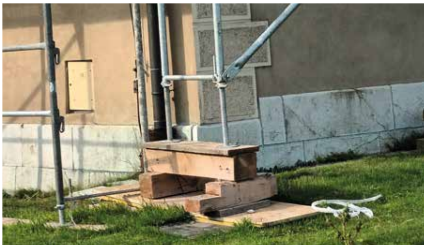
Fot. 3. Przykład nieprawidłowego posadowienia rusztowania
