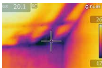
Fot. 6. Termogram. Poddasze mieszkalne, ocieplone: przy murłacie, na krokwi i łacie oraz przy ścianie szczytowej widoczne „języki zimna” – nieszczelności, brak wełny przy krokwi i w narożu
