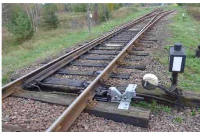
Fot. 1. Rozjazd z dźwignią ręczną
