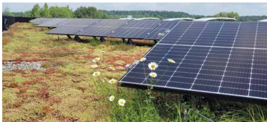
Fot. 1. Dach biosolarny na obiekcie biurowo-magazynowym pod Krakowem
