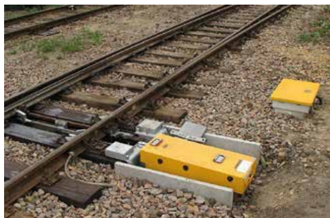
Fot. 2. Rozjazd z napędem elektrycznym
