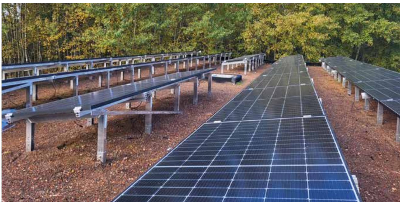
Fot. 6. Panele fotowoltaiczne zintegrowane z warstwami dachu zielonego
