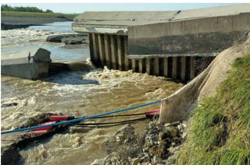
Fot. 3. Zniszczony przelew awaryjny zapory Topola w trakcie powodzi we wrześniu 2024 r.
