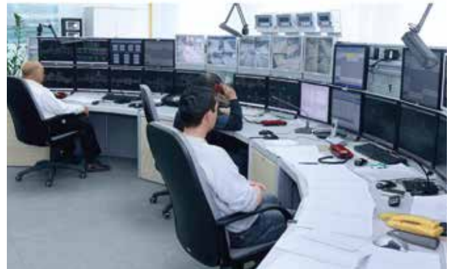
Fot. 4. Urządzenia komputerowe
