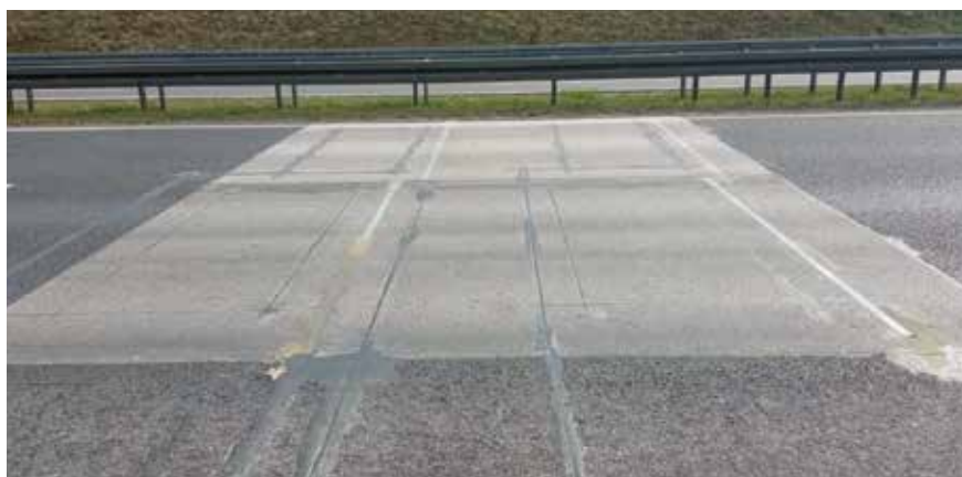
Fot. 2. Stacja ważenia pojazdów WIM w ciągu drogi S3
