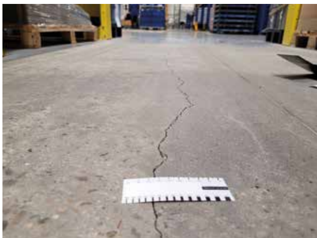
Fot. 7. Zarysowanie posadzki w trakcie między regałami wysokiego składowania (1,4 mm)
