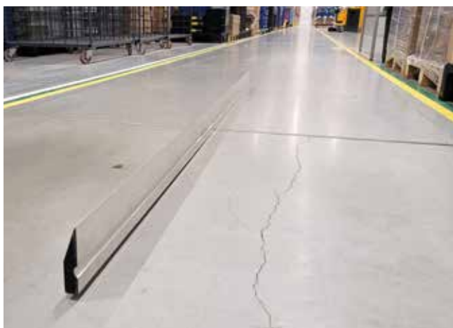
Fot. 4. Zarysowanie posadzki w pobliżu dylatacji
