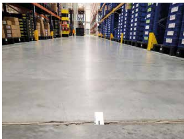
Fot. 9. Przykład uszkodzeń dylatacji roboczej
