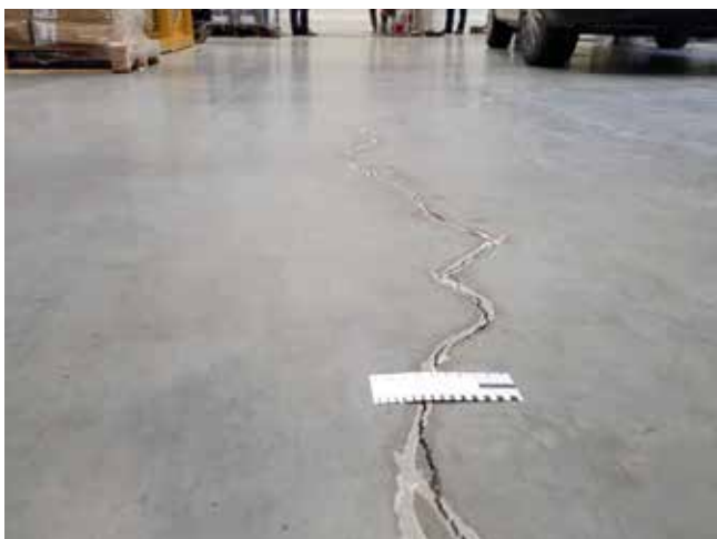
Fot. 6. Poszerzenie rysy w głównym trakcie jezdnym (1,6 mm)
