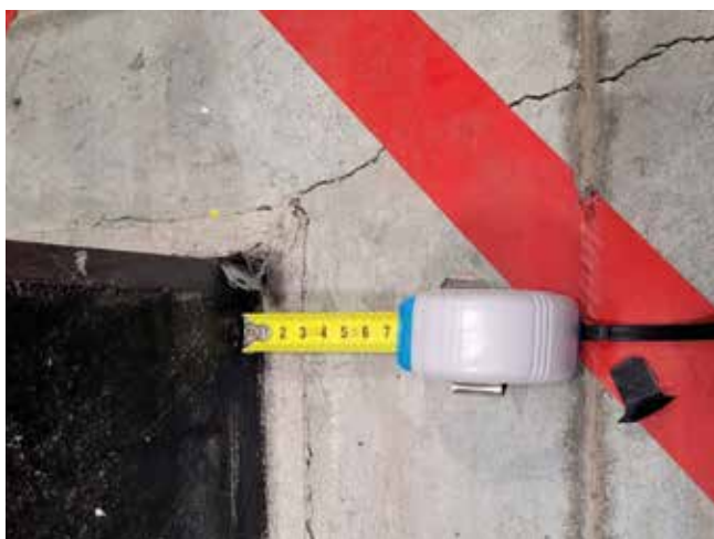
Fot. 2. Grubość pianki polietylenowej przy jednym ze słupów hali
