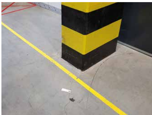
Fot. 3. Zarysowanie posadzki przy jednym ze słupów hali
