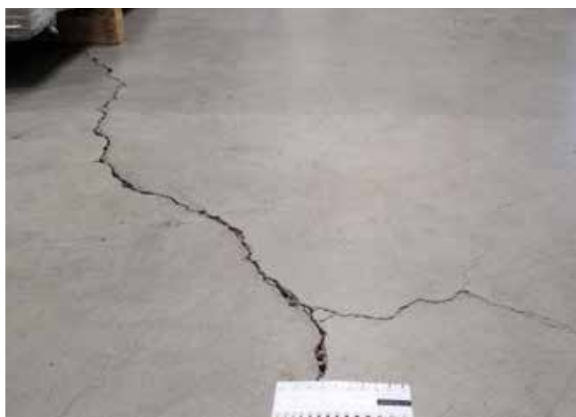
Fot. 5. Zarysowanie posadzki w głównym trakcie jezdnym (1,8 mm)
