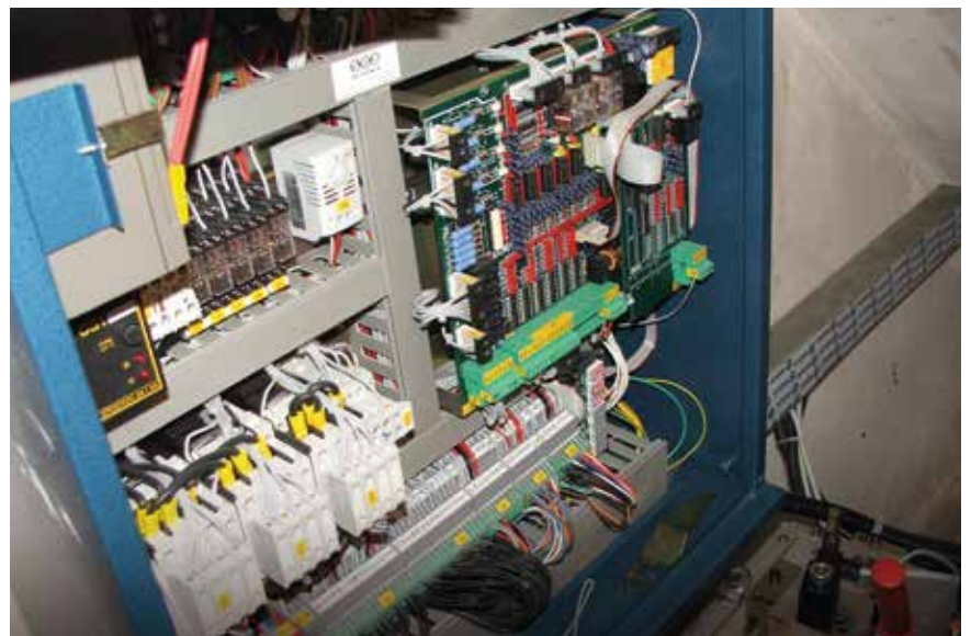
Fot. 2. Aparatura sterowa dźwigu hydraulicznego, która umożliwia oddawanie energii do sieci podczas jazdy kabiny w dół
