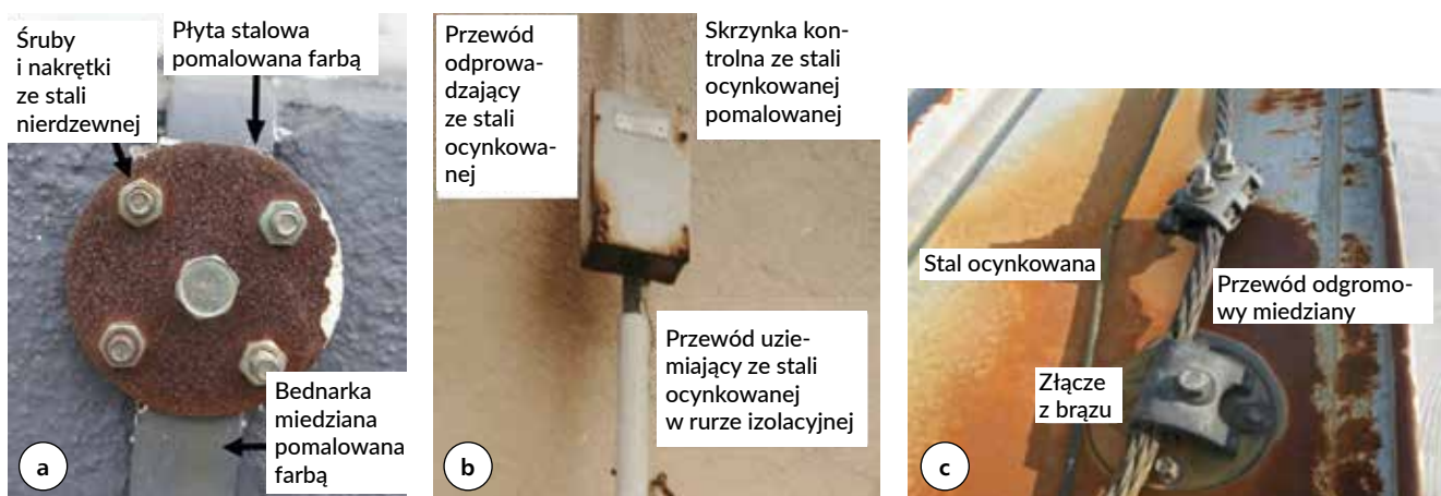
Fot. 4. Skorodowane elementy LPSC: a) wielopunktowy styk kilku metali (miedzi, stali gołej i ocynkowanej) z powierzchniami stalowymi pomalowanymi, b) styk pomalowanej skrzynki ze stali ocynkowanej z ocynkowanym przewodem stalowym uziemiającym i przewodem odgromowym (ze stali ocynkowanej pomalowanej), c) poziomy, miedziany przewód odgromowy i złącze z brązu stykające się z blachą ze stali ocynkowanej [17]
