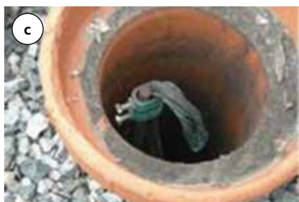
Fot. 1. Przykłady korozji przewodów uziemiających (doprowadzających): a) stalowy pręt ocynkowany na gorąco po 6 miesiącach eksploatacji w Sudanie, b) stalowa bednarka ocynkowana po 12 latach eksploatacji w Polsce, c) złącze kontrolne ze stalowym uzieniem ocynkowanym połączonym z miedzianym przewodem uziemiającym (brak danych o okresie eksploatacji)
