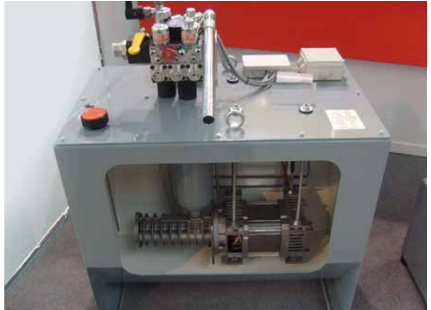
Fot. 1. Zespół napędowy dźwigu hydraulicznego
