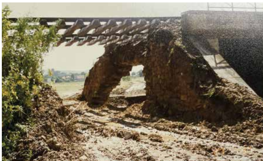
Fot. 1. Linia kolejowa nr 276 Wrocław-Praga – przykład rozmycia strefy zaprzeczółkowej obiektu oraz konstrukcji murewanej przyczółka mostu kolejowego na skutek powodzi w 1997 r.
