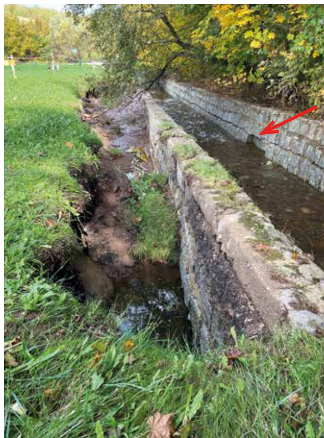
Fot. 10. Przykład wpływu pierwotnych uszkodzeń muru oporowego (ubytki i spękania) na szkody popowodziowe (stabilizująca zasypka gruntowa za konstrukcją muru)
