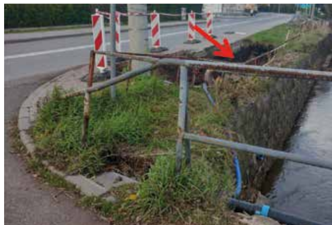
Fot. 8. Widok muru oporowego w obrębie obiektu mostowego. Widoczne wymycie gruntu za konstrukcją muru oporowego (patrz też rys. 7)
