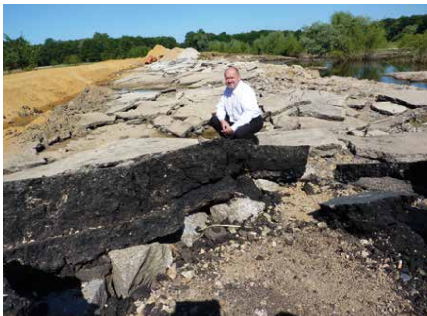
Fot. 2. Skutki powodzi w 2010 r. – autor na tle katastrofy budowlanej drogi wojewódzkiej nr 315 w województwie lubuskim, powstałej w wyniku wystąpienia z koryta rzeki Odry
