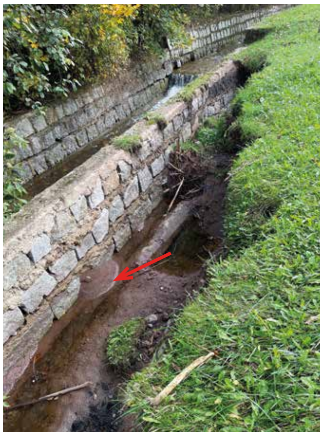
Fot. 9. Szczegół skutków przesiąków wody od strony cieku do gruntu nasypu na skutek lokalnych ubytków muru oporowego (wymycie zasypki od strony zewnętrznej)
