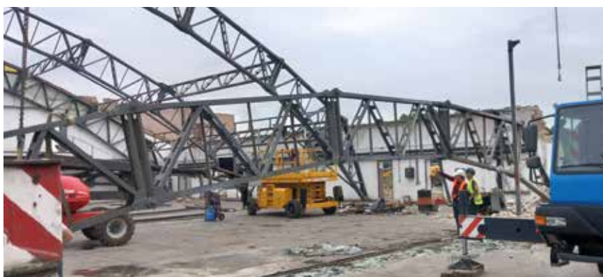
Fot. 6. Obniżenie elementów kratownic KR1-8, KR1-9, KR1-10, KR 1-11 i KR1-12 do poziomu posadzki
