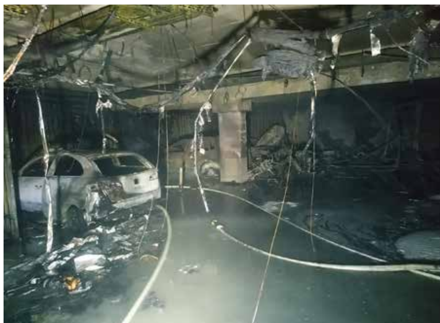
Fot. 2. W wyniku pożaru częściowego uszkodzeniu uległa konstrukcja budynku, instalacje oraz pojazdy znajdujące się w garażu podziemnym [16]
