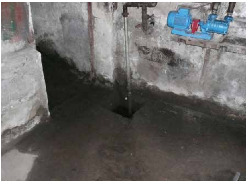
Fot. 5. Bywa, że woda dostaje się do budynku przez otwory w posadzce, które mają służyć do odprowadzenia wody zalewającej piwnicę
