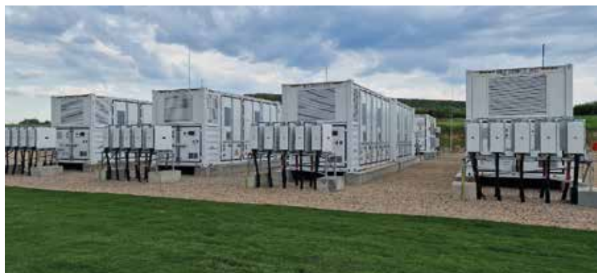
Fot. 2. Baterijny magazyn dużej mocy, współpracujący z jednostką wytwórczą typu C
