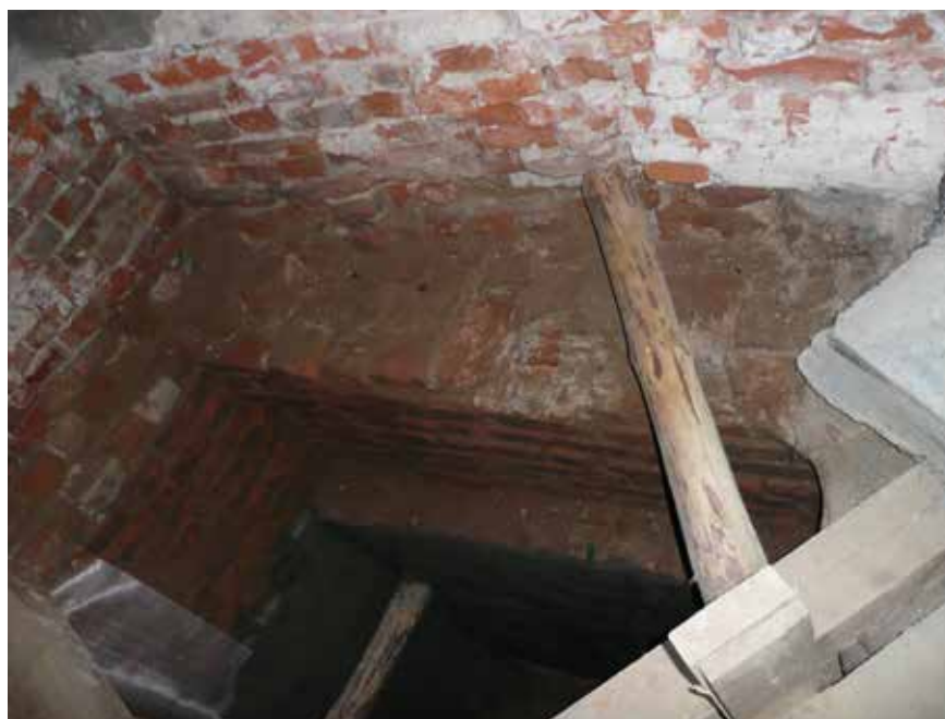
Fot. 8. Odsadzki ceglanej ławy fundamentowej potrafią znacznie utrudnić wykonanie wtórnych izolacji pionowych
