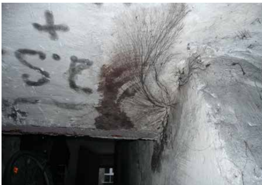
Fot. 9. Wychodzące ze ściany w piwnicy sznury grzyba niszczącego drewno. Wygląd sznurów – cienkie, nitkowane, brunatne o średnicy ok. 1 mm, tworzące siateczkę – jednoznacznie wskazuje na grzyba piwnicznego ( Coniophora puteana )
