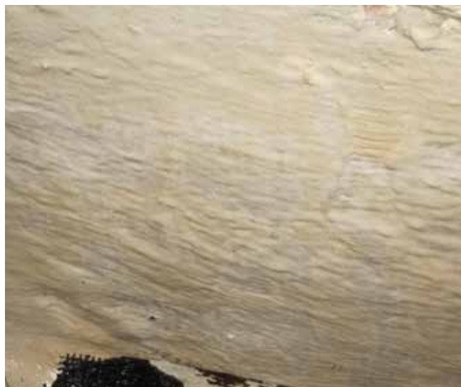
Fot. 4. Izolacja wannowa nie sprawdza się w sytuacji, gdy przyczyną zawilgocenia jest kondensacja wilgoci
