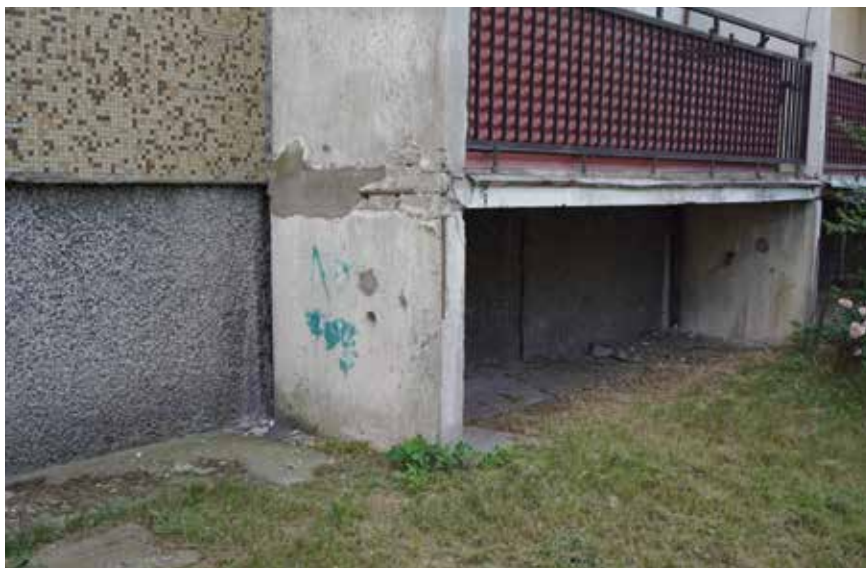
Fot. 1. Widok zniszczonego węzła konstrukcji loggii – system szczeciński, Poznań, 2021 r.
