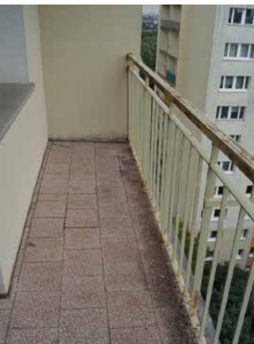
Fot. 2. Widok loggii ze zmniejszoną szerokością użytkową na skutek docieplenia ściany zewnętrznej budynku – system szczeciński, Poznań, 2021 r.
