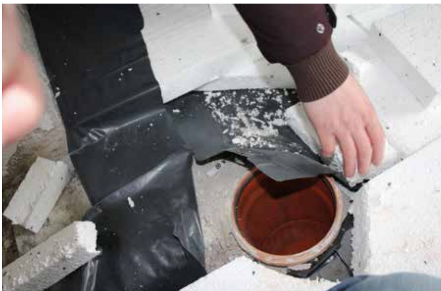
Fot. 1–3. Przykład błędnego zastosowania folii o grubości 0,2 mm jako izolacji przeciwwodnej
