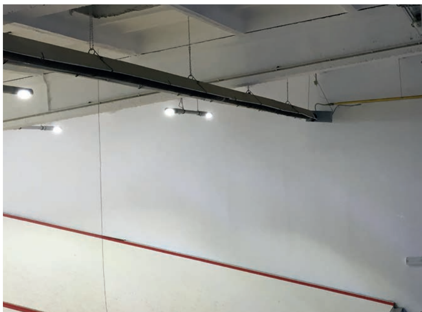
Fot. 1. Rurowy promiennik gazowy w hali sportowej
