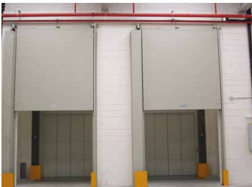
Fot. 4. Bramy przeciwpożarowe opuszczane pionowo
