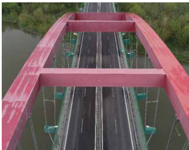
Fot. 1. Miejscowa degradacja powłoki nawierzchniowej w środowisku przemysłowym ze zwiększoną zawartością związków azotu
