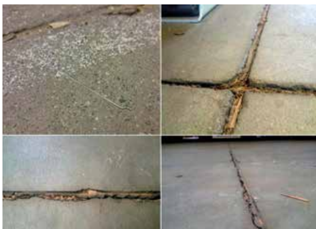
Fot. 11 i 12. Przykłady uszkodzeń dylatacji
