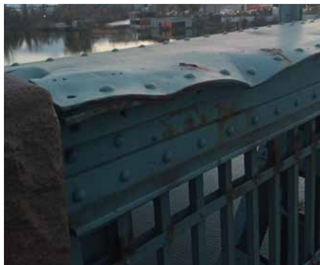
Fot. 2. Rozsadzone przez produkty korozji szczeliny w balustradzie mostu
