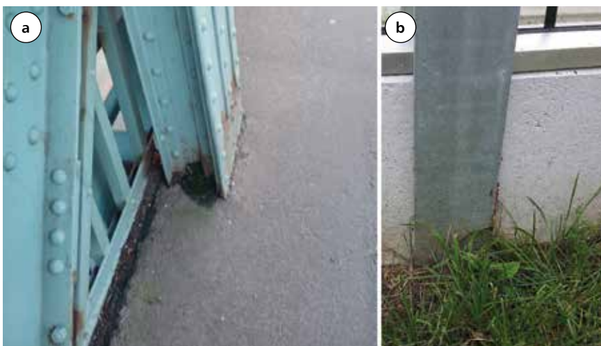
Fot. 3. Widok korozji elementów stalowych: a) przechodzących przez asfaltowy chodnik b) mających kontakt z gruntem
