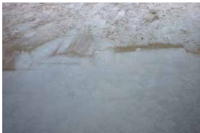
Fot. 6. Podłoga betonowa zanieczyszczona piaskiem
