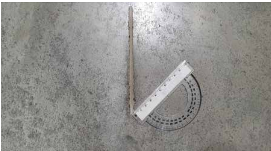
Fot. 10. Uszkodzenie mechaniczne powierzchni posadzki
