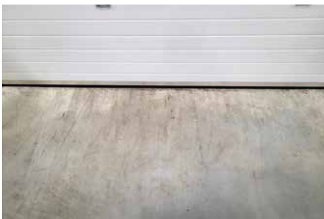
Fot. 8. Typowe zużycie powierzchni podłogi w pobliżu bramy wjazdowej
