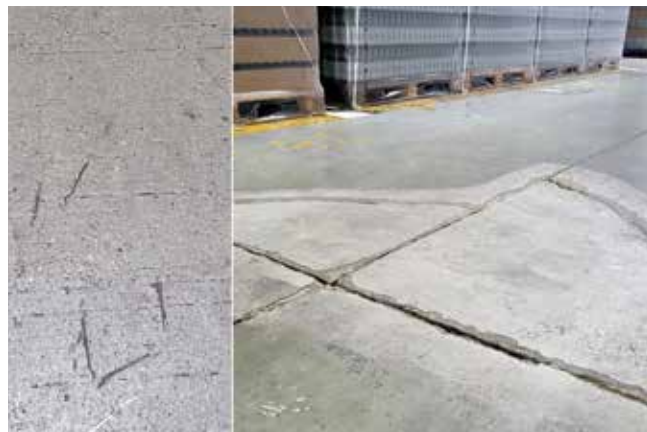
Fot. 2. Wybrane uszkodzenia podłogi przedstawionej na fot. 1
