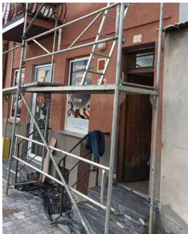
Fot. 5. Miejsce upadku poszkodowanego z najniższego poziomu rusztowania
