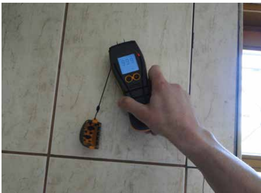
Fot. 2. Maksymalne wskazanie wilgotnościomierza pod płytkami we wnętrzu pomieszczenia
