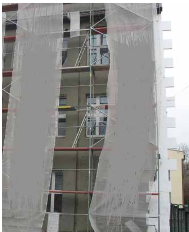
Fot. 1. Miejsce pracy, gdzie doszło do upadku pracownika pomiędzy rusztowaniem a ścianą budynku
