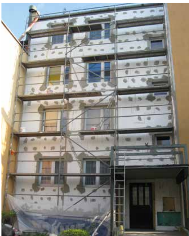
Fot. 4. Poszkodowany spadł z poziomu, na którym widoczny jest plastikowy pojemnik
