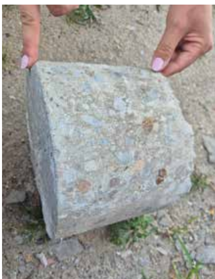
Fot. 2. Widok odwiertu rdzeniowego ze stropu – brak zbrojenia górnego
