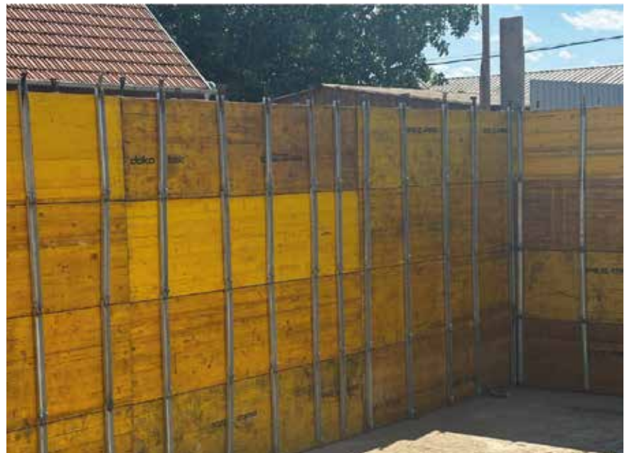
Fot. 1. Deskowanie ścian wykonane z płyt trójwarstwowych, ściąganych za pomocą stalowych pasków krępowanych klinami
