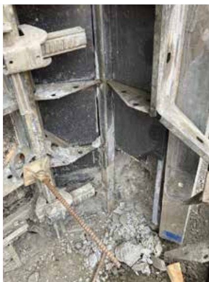
Fot. 2. Deskowanie, które uległo awarii wskutek pęknięcia ściągu szalunkowego. Główną przyczyną zdarzenia były błędy montażowe, skutkujące znacznym przeciążeniem elementu ściąającego
