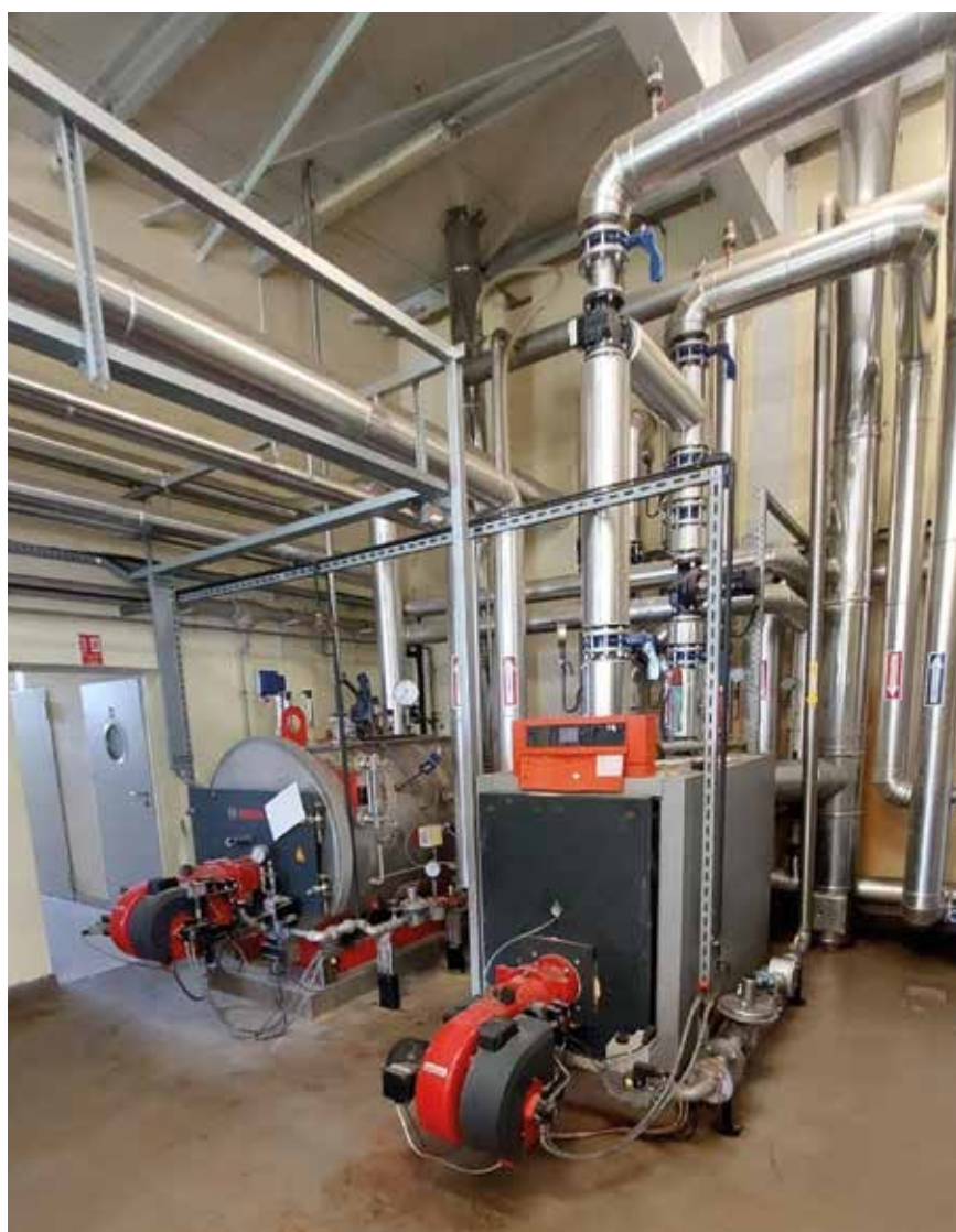
Fot. 2. Kocioł na biogaz w oczyszczalni ścieków w Łąncucie (woj. podkarpackie)
