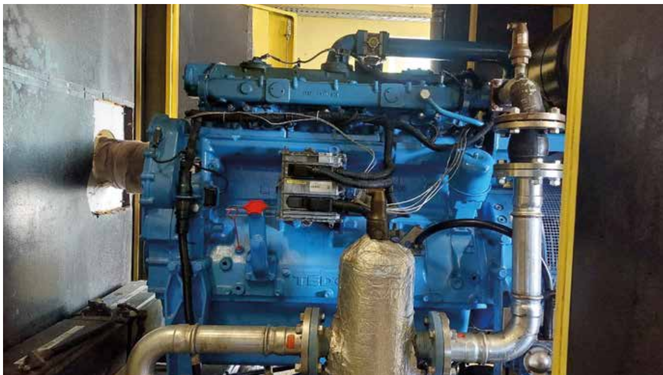
Fot. 1. Silnik do spalania biogazu (kogeneracja) w oczyszczalni ścieków w Łańcucie (woj. podkarpackie)
