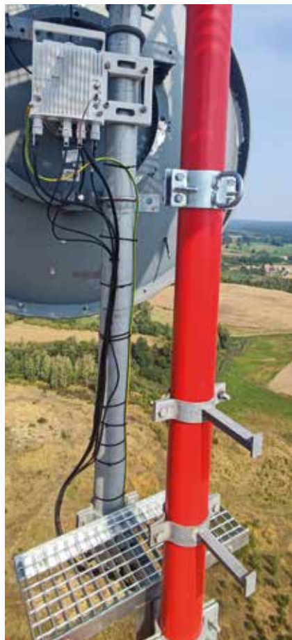
Fot. 11. Uchwyt asekuracyjny na wieży
