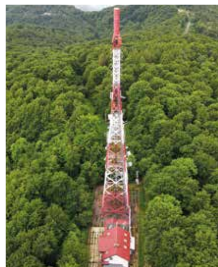
Fot. 14. Obiekt telekomunikacyjny w terenie zalesionym
