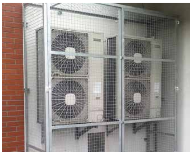
Fot. 4. Klatki zabezpieczające jednostki zewnętrzne klimatyzatorów
