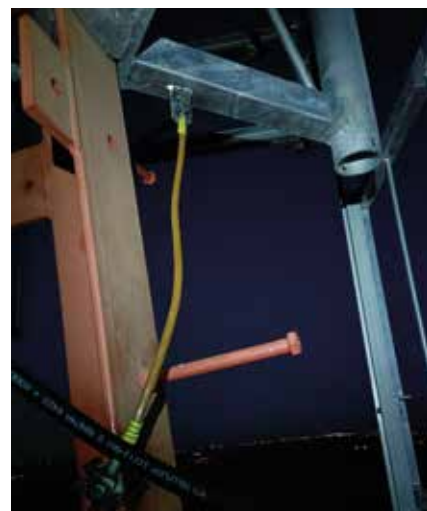
Fot. 12. Połączenia wyrównawcze konstrukcji i opaski uziomowe kabli antenowych
