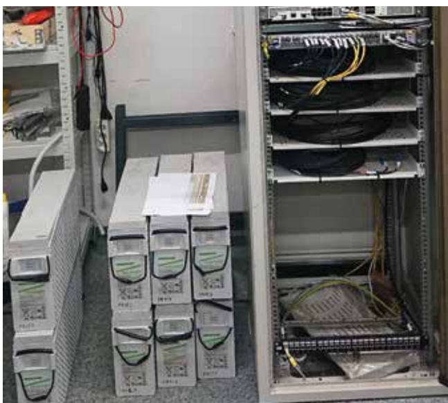
Fot. 7. Akumulatory do siłowni 48VDC podtrzymujących pracę stacji w trakcie wyłączeń głównej linii zasilającej
