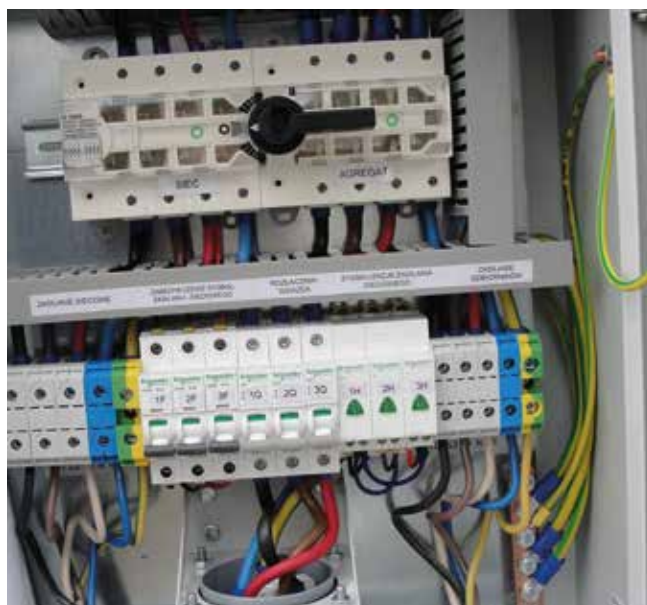
Fot. 8. Przełącznik mechaniczny zasilania agregat-sieć
