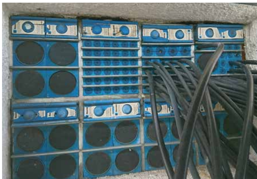
Fot. 9. Przykładowe przepusty kablowe zabezpieczające wejście kabli do pomieszczenia
