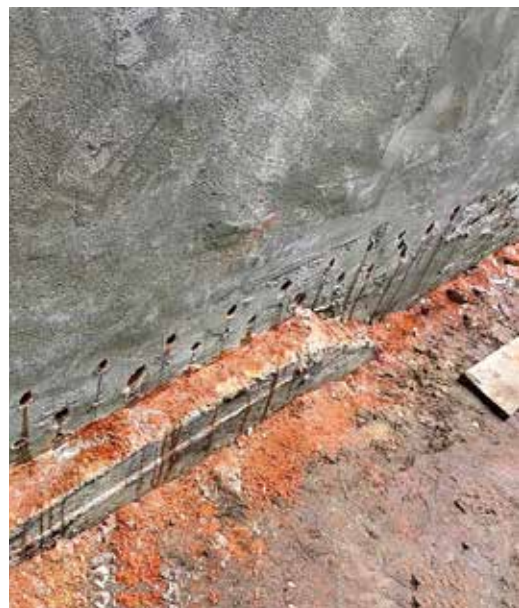
Odtworzenie izolacji poziomej z użyciem Hydrostopu-Płynu Iniekcyjnego nr 742 w ceglany fundament budynku Szpitala MSWiA w Gdańsku (2024 r.)
