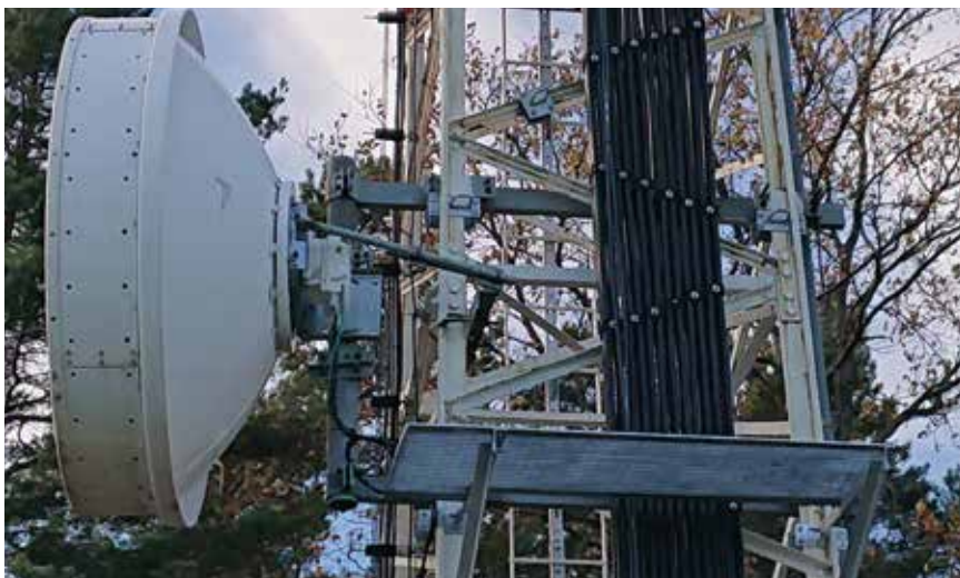
Fot. 10. Pomost roboczy do obsługi konkretnej anteny, w tym przypadku linii radiowej
