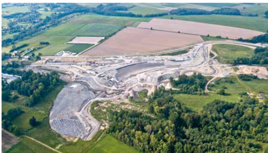
Fot. 3. Korpus zapory w trakcie budowy wraz z postępowaniem przy wykonaniu urządzeń przelewowych i spustowych
