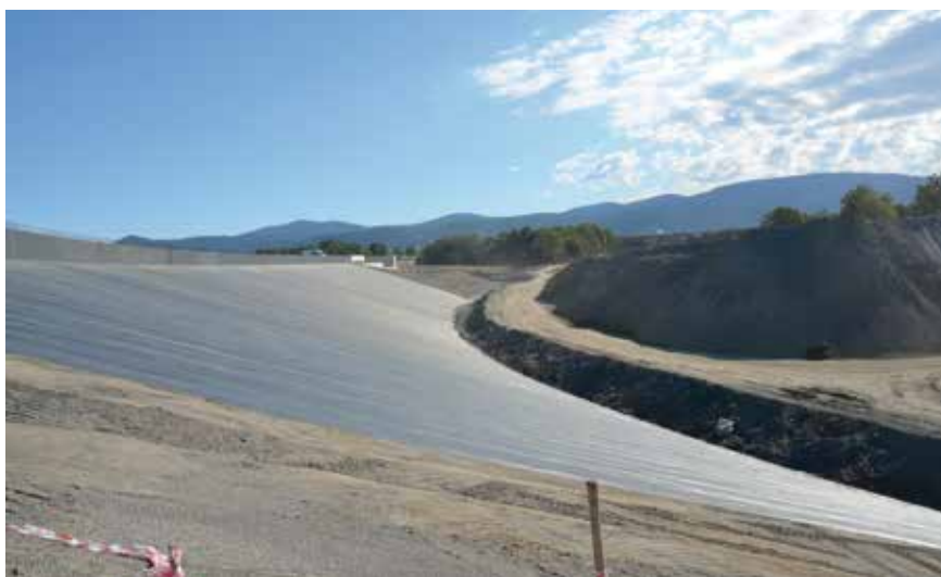
Fot. 4. Uszczelnienie korpusu zapory z wykorzystaniem geomembrany PVC przed wykonaniem zasyпки warstwą filtracyjną
