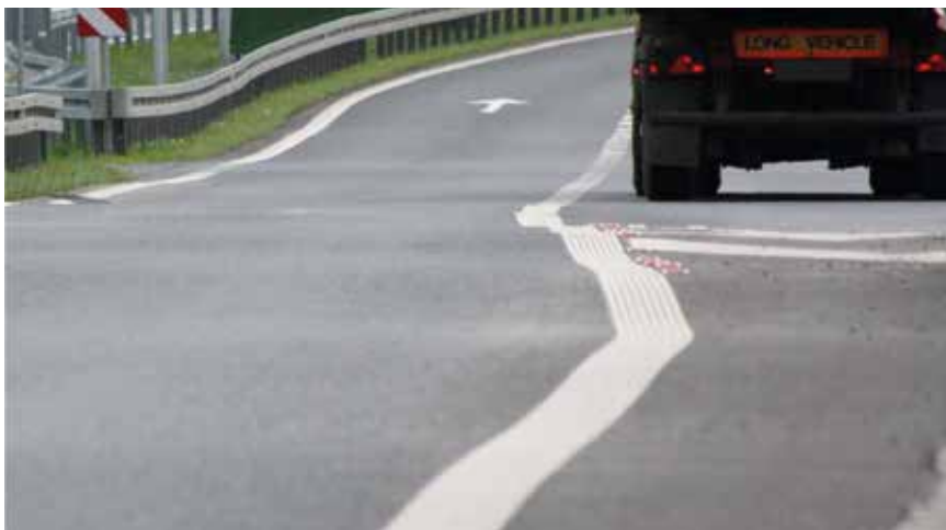
Fot. 1. Wypiętrzenia spowodowane stosowaniem dodatku popiołu do budowy warstw nasypowych drogi
