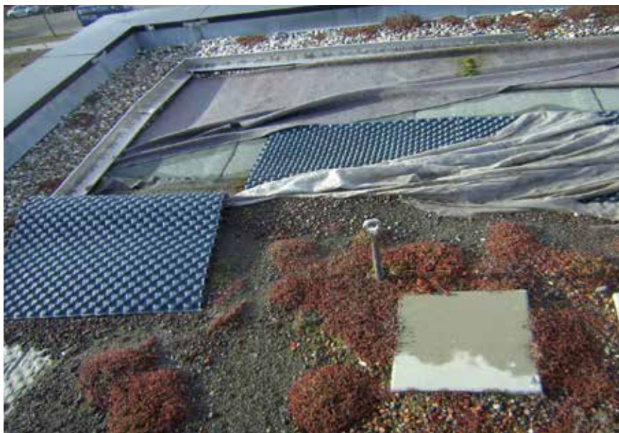
Fot. 4–5. Skutki erozji wietrznej na dachu zielonym
