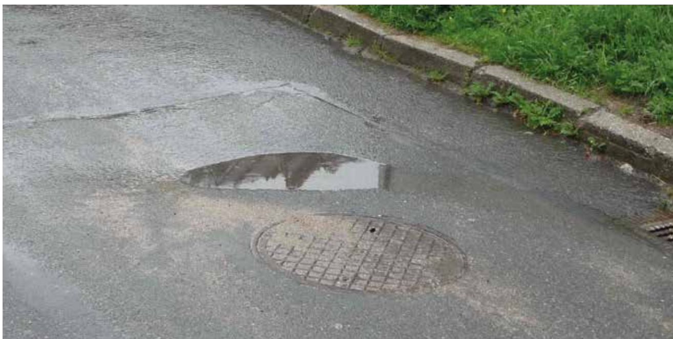
Fot. 1. Zapadnięta nawierzchnia uliczna w wyniku rozszczelnienia połączenia rurociągu ze studzienką
