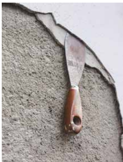
Fot. 2. Przykładowe uszkodzenie tynku na elewacji budynku ratusza
