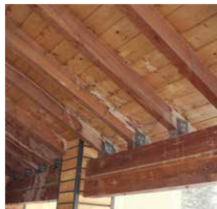
Fot. 5. Korozja biologiczna elementów przekrycia
