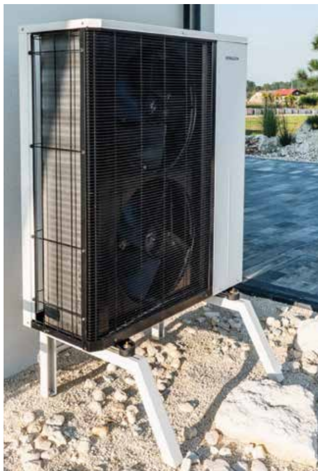
Fot. 1. Urządzenie klimatyzacyjne – jednostka zewnętrzna [5]
