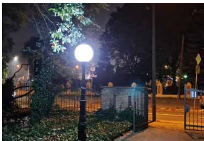
Fot. 4. Oświetlenie drogi w parku oprawą oświetleniową typu kula mleczna
