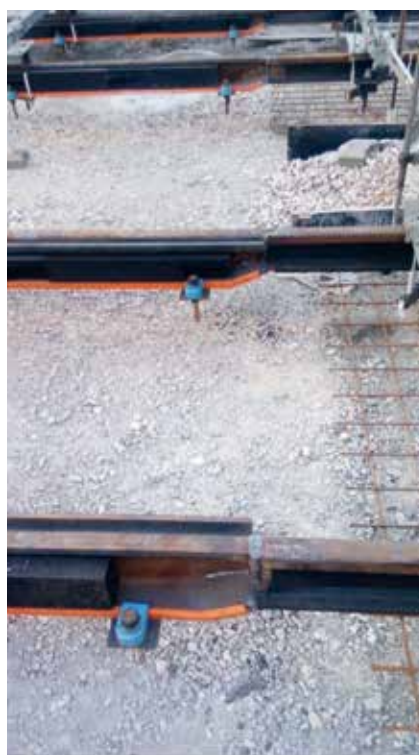
Fot. 2. Ruszt torowy przejścia szyn kolejowych w tramwajowe. Pod szynami kolejowymi widoczna stalowa siatka wzmacniająca, która się znajduje pod płytą betonową. Wsparcie bramek zawieszania szyn kolejowych może zwierać szyny z siatką. Metalowe bramki zwierają zarówno szyny kolejowe, jak i tramwajowe. Łączniki międzytorowe na bramkach decydują, czy pomiar konduktancji będzie dotyczył jednego toru czy obydwu jednocześnie. Zaproponowane przytwierdzenie szyny tramwajowej ma cechy kłopotliwego „elektrycznie” węzła, co może się ujawnić po wypełnieniu przestrzeni międzyszynowych torowiska.
