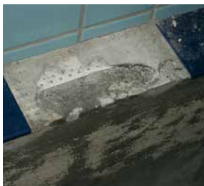
Fot. 2. Skutek braku taśmy w narożniku wypukłym
