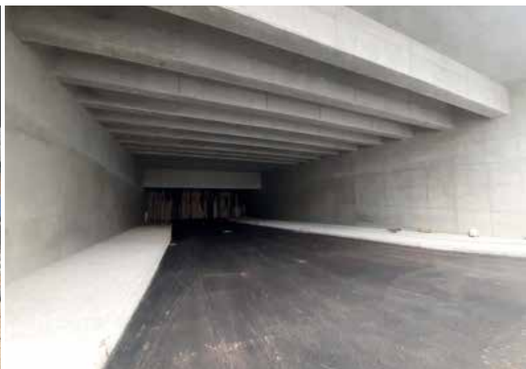
Fot. 15. Część tunelowa, z tyłu palisada tymczasowa, a u góry przejście dla mediów
