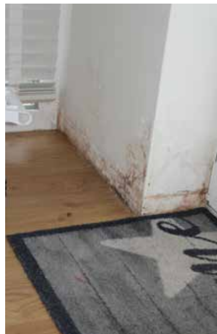
Fot. 1. Skutek błędów w wykonaniu izolacji budynku niepodpiwniczonego, posadowionego na płycie
