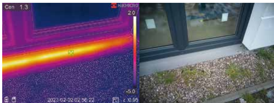
Fot. 3. Liniowy mostek termiczny przy drzwiach na taras naziemny
