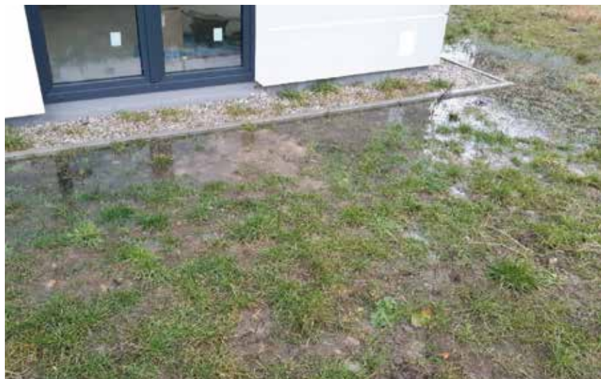
Fot. 2. Zaleganie wody na powierzchni otaczającego terenu – dla takiego obiektu musi być wykonana izolacja typu ciężkiego
