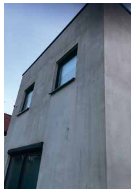
Fot. 7. Skażenie mikrobiologiczne występujące na elewacji budynku
