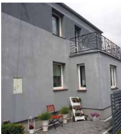
Fot. 5-6. Wysolenia na ścianie budynku mieszkalnego
