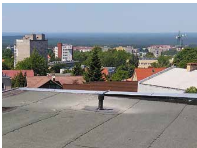
Fot. 5. Komin wentylacyjny – częsty sposób zamykania otworów instalacyjnych
