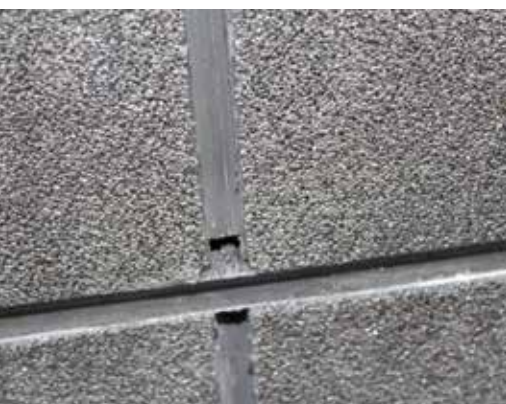
Fot. 5. Łączenie boni poziomych z elementami pionowymi to potencjalne miejsce późniejszych zawilgoceń
