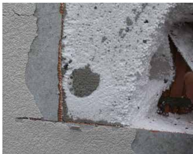
Fot. 2. Brak właściwej przyczepności warstwy zbrojącej do termoizolacji – rezultat rozwinięcia siatki na płytach termoizolacyjnych i przespachlowaniu jej klejem
