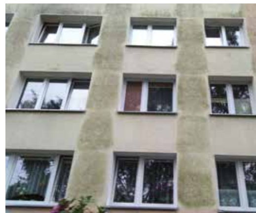
Fot. 9. Porażenie biologiczne elewacji. Często przyczyną jest brak obliczeń cieplno-wilgotnościowych
