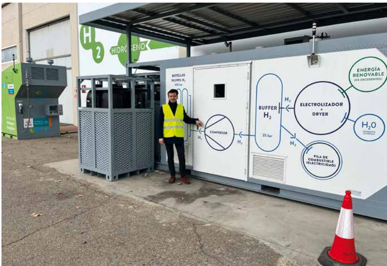
Fot. 4. System do wytwarzania i stacja tankowania wodoru, Saragossa, Hiszpania
