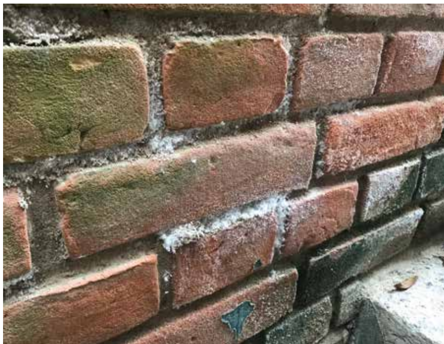
Fot. 1. Wykwity solne na zawilgotnionym murze
