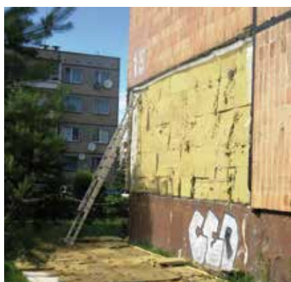
Fot. 3. Widok ściany szczytowej budynku po oderwaniu się warstwy fakturowej
