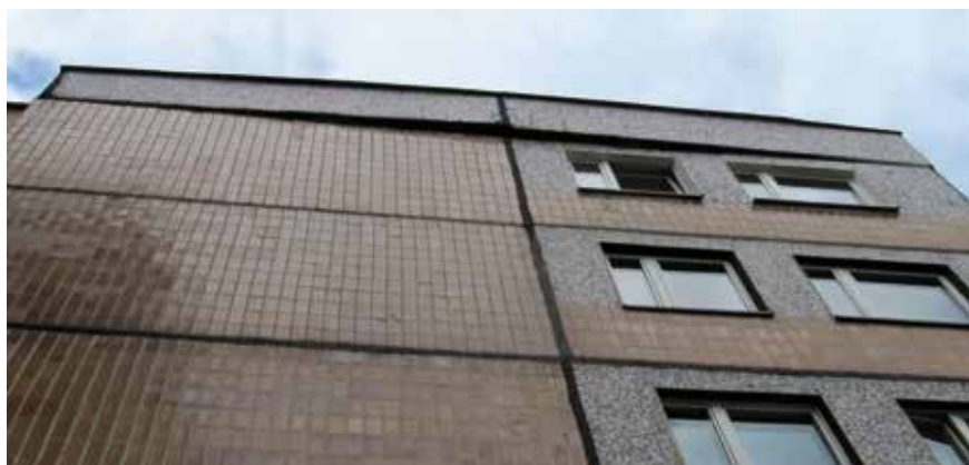
Fot. 7. Wysunięte ścianki kolankowe stropodachu
