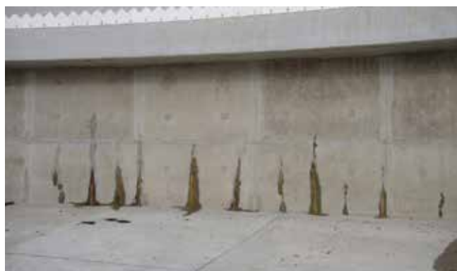
Fot. 11. Wycieki wody przez ściany żelbetowego zbiornika walcowego
