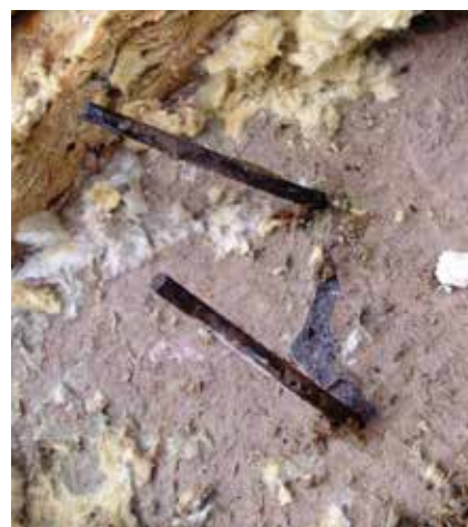
Fot. 4. Zerwane pręty części wieszaka zakotwionego w warstwie fakturowej
