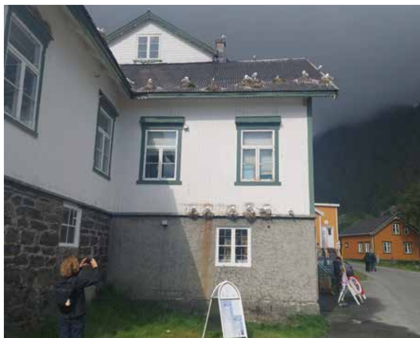
Fot. 4. Nietypowe obciążenie dachu
