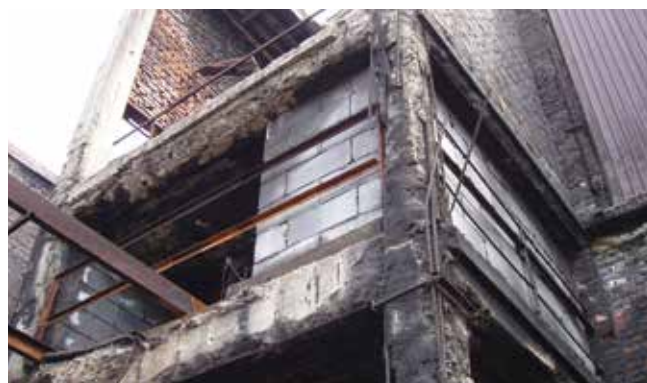
Fot. 15. Zniszczenia korozyjne żelbetowego szkieletu
