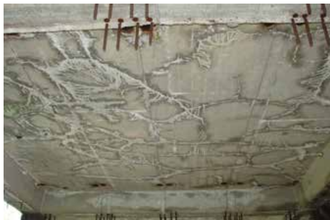
Fot. 13. Siatka rys skurczowych na żelbetowym stropie
