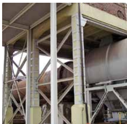
Fot. 16. Zniszczona korozyjnie konstrukcja budynku przemysłowego, która została naprawiona i wzmocniona elementami stalowymi
