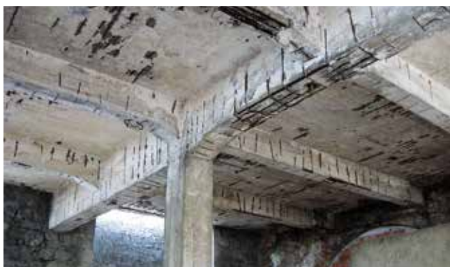
Fot. 14. Uszkodzony przez korozję strop żelbetowy
