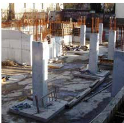
Fot. 2. Wycieki wody przez dno i ściany skrzyni
