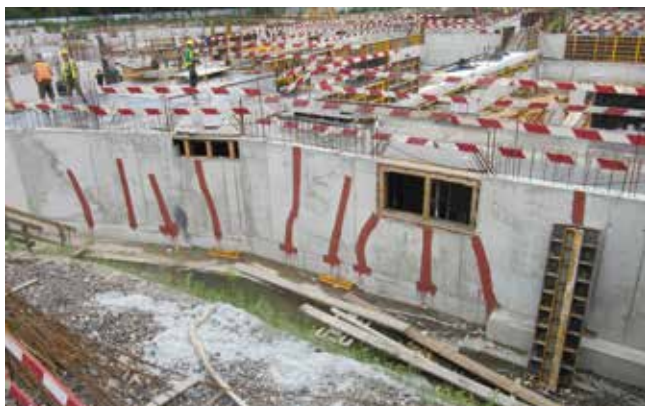
Fot. 12. Ślady po naprawach rys termiczno-skurczowych na żelbetowych ścianach realizowanego obiektu
