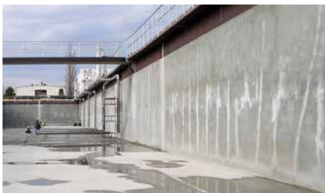
Fot. 10. Ślady po naprawach rys skurczowych na ścianach żelbetowego zbiornika
