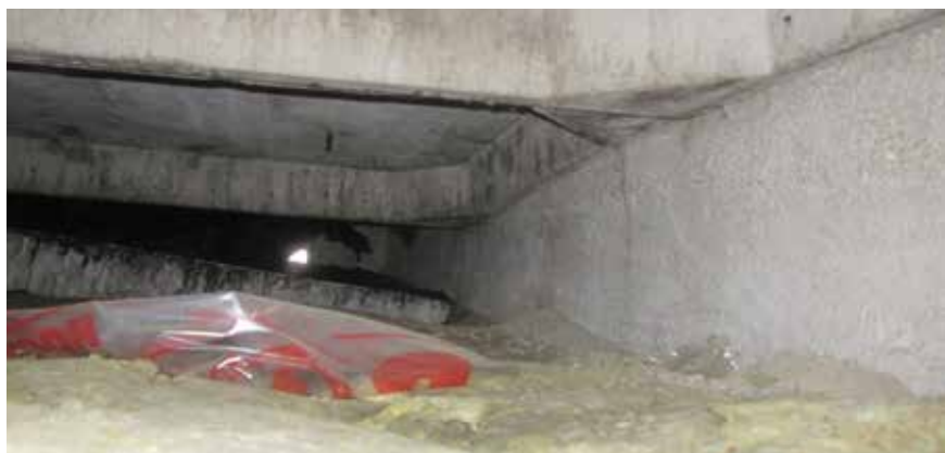
Fot. 6. Awaria dachu – osunięta z podpory płyta dachowa
