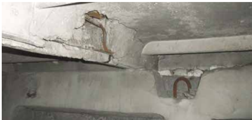
Fot. 5. Uszkodzone żebra nośne dachowych płyt panwiowych
