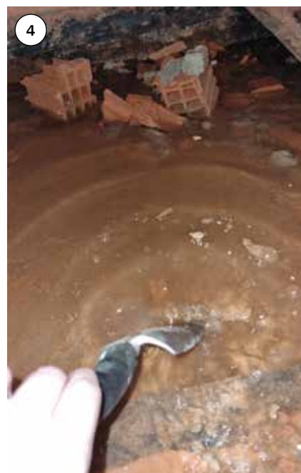
Fot. 2–4. Przykład poważnego błędu wykonawczego: skutki zastosowania jako hydroizolacji folii o grubości 0,1 mm
