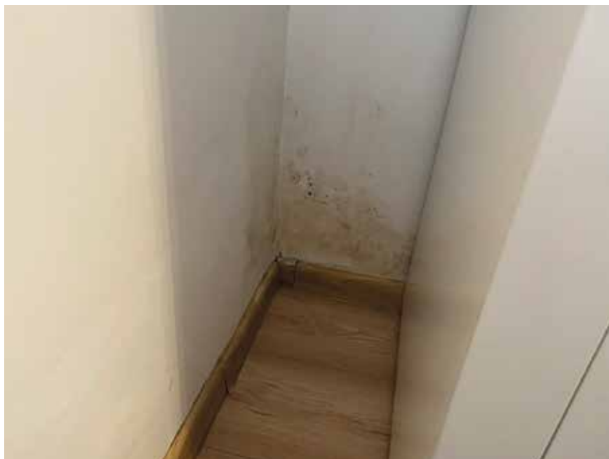
Fot. Porażenie biologiczne w narożniku pomieszczenia spowodowane nadmiernym zawilgoceniem przegrody oraz niewystarczającą wentylacją
