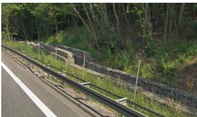
Fot. 2. Rów odwadniający o wzmocnionej skarpie
