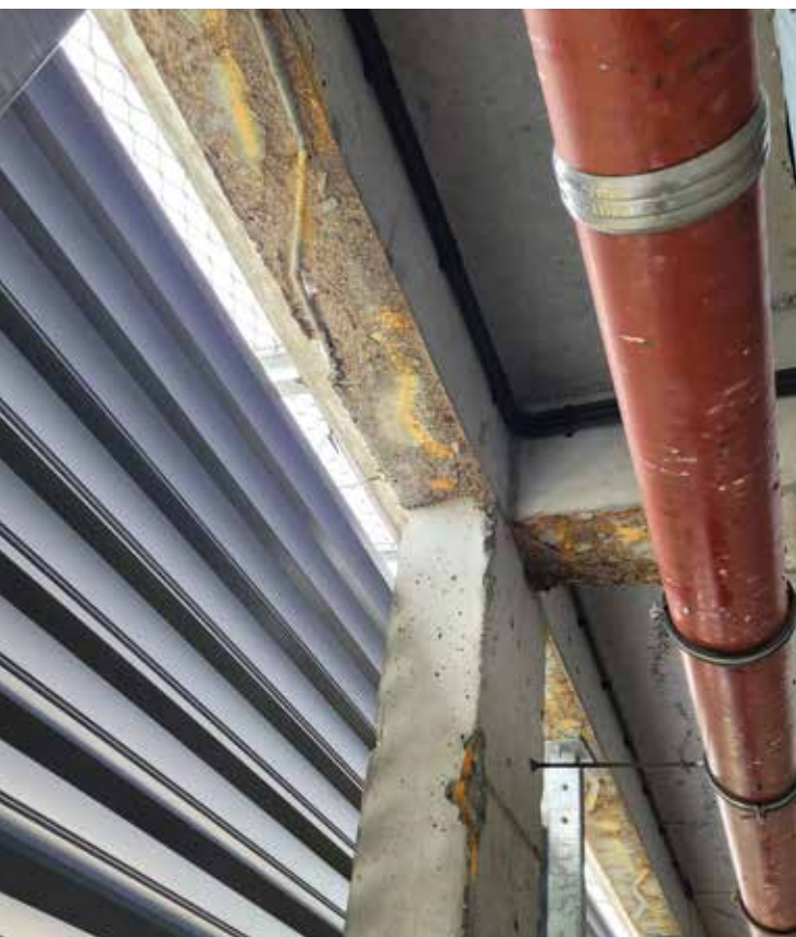
Fot. 1. Przykład konstrukcji żelbetowej wykonanej bez uprzedniego oczyszczenia wnętrza deskowania z trocin
