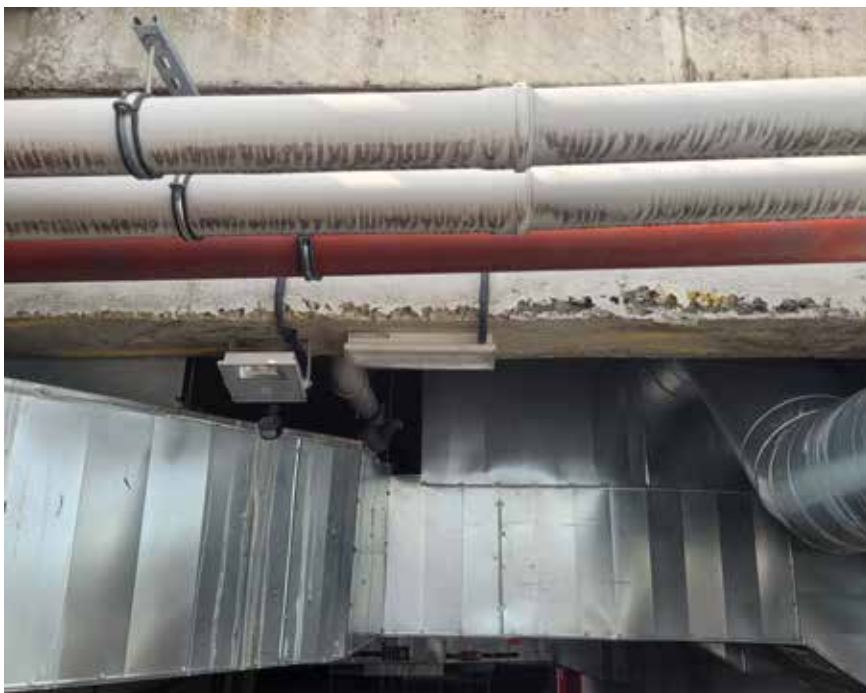
Fot. 9. Konstrukcja belki żelbetowej z „rakami”
