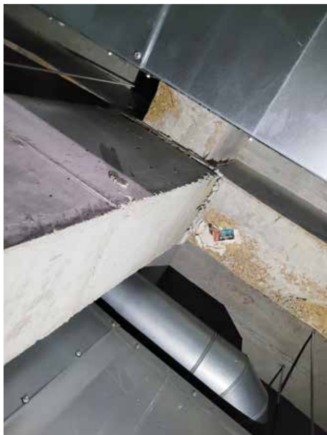
Fot. 2. Przykład konstrukcji żelbetowej wykonanej bez uprzedniego oczyszczenia wnętrza deskowania z zanieczyszczeń
