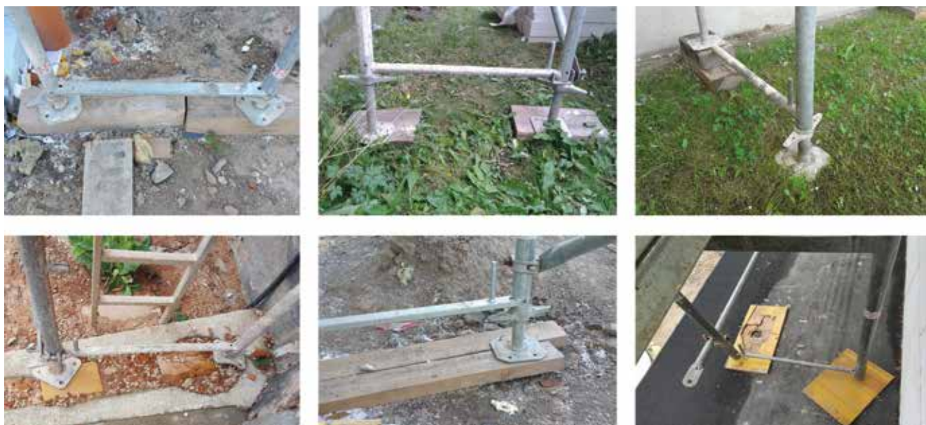
Fot. 2. Przykłady nieprawidłowego ustawienia na podkładach
