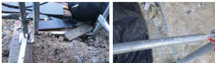
Fot. 1. Przykłady zapadniętych w gruncie podkładów
