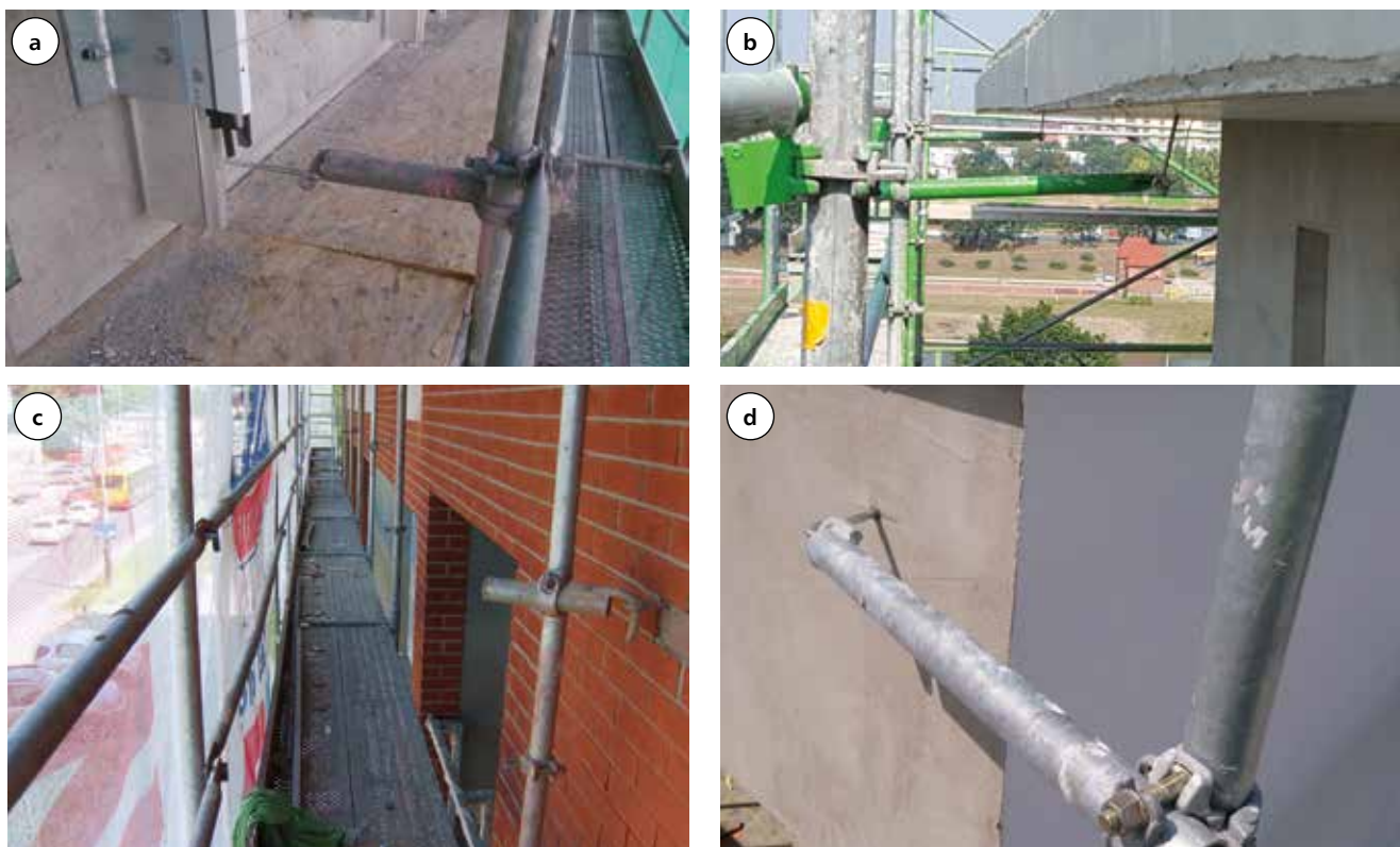
Fot. 3. Przykłady nieprawidłowego kotwienia: a) długie pręty kotew, b, d) kotwy połączone z łącznikami pod innym kątem niż półpełny, c) łącznik kotwiący połączony ze słupkiem w połowie wysokości
