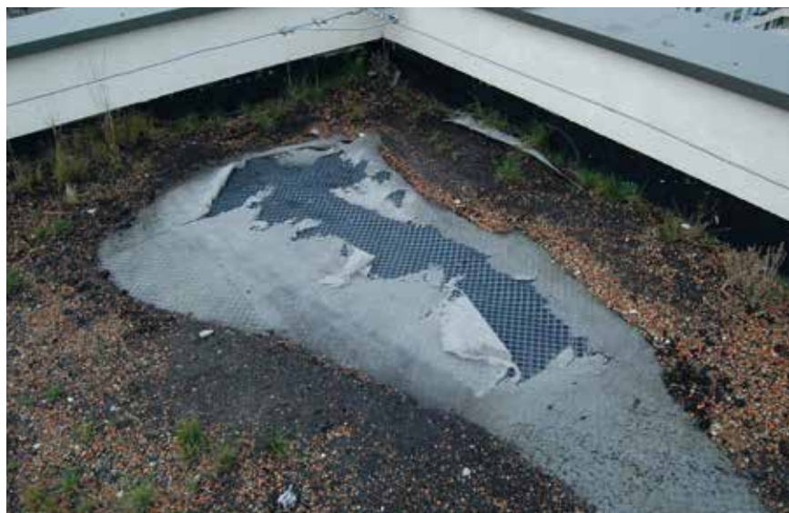
Fot. 1. Geowłóknina filtracyjna zdegradowana przez promieniowanie UV
