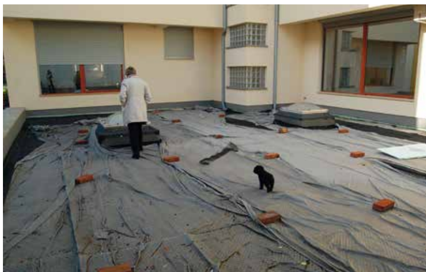
Fot. 7. Żle ułożona geowłóknina i konieczność jej ponownego położenia
