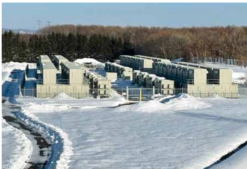
Rys. 3. Magazyn energii na bazie akumulatorów wanadowych o mocy 17 MW i pojemności 52 MWh, ukończony w kwietniu 2022 r. przez japońską firmę Sumitomo Electric dla spółki energetycznej Hokkaido Electric Power Co. Inc. (HEPCO)
