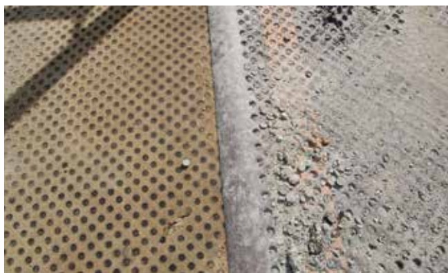
Fot. 2. Brak geowłókniny pod drenażem spowodował trwałe wgniecenia termoizolacji
