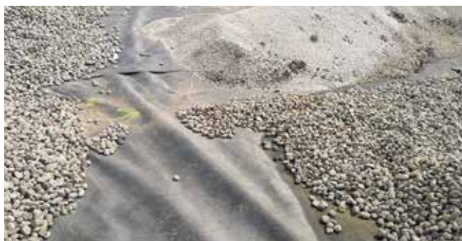
Fot. 5. Geowłóknina przeciwkorzenna klasy GRK 5 ułożona na hydroizolacji na dachu zielonym bagiennym
