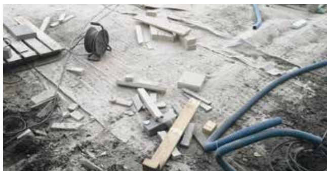
Fot. 6. Geowłóknina trwale zanieczyszczona resztkami cementu i śmieciami budowlanymi
