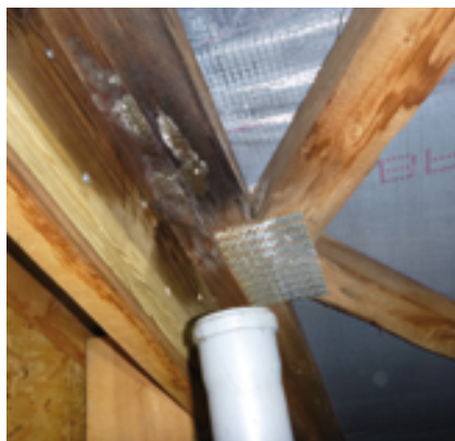
Fot. 13. Brak wyprowadzenia wentylacji ponad połac dachu – miejscowa degradacja drewna
