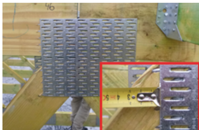
Fot. 3. Przesunięcie płytek względem siebie w węźle. Niepoprawne wprasowanie płytki – brak zakotwienia kołców. Niedopuszczalna szczelina między elementami
