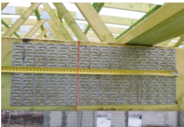
Fot. 2. Niesymetrycznie umiejscowiona płytki w styku
