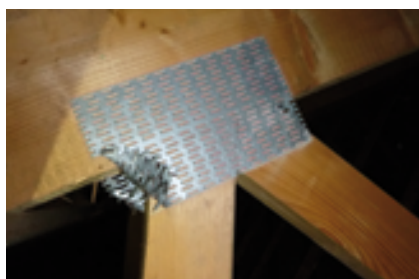
Fot. 6. Uszkodzona podczas montażu płytka
