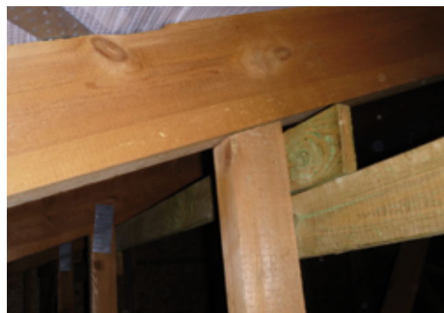
Fot. 5. Brak płytki w węźle
