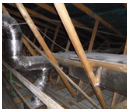
Fot. 11. Niewłaściwe umiejscowienie centrali – zginanie krzyżulców projektowanych tylko na siły osiowe
