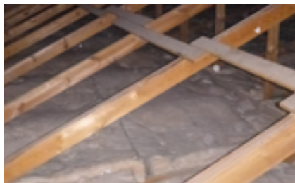
Fot. 7. Jednoprzęsłowe stężenia montażowe pozostawione jako konstrukcyjne
