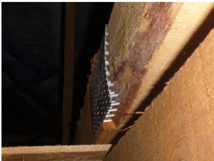
Fot. 1. Wiązar wykonany z nieokorowanego drewna o niedopuszczalnej oblinie, zmniejszającej powierzchnię czynną płytki
