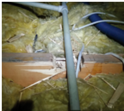
Fot. 12. Wycięty fragment pasa w celu przeprowadzenia instalacji – osłabienie przekroju
