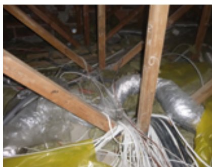
Fot. 14. Niepoprawne prowadzenie przewodów elektrycznych
