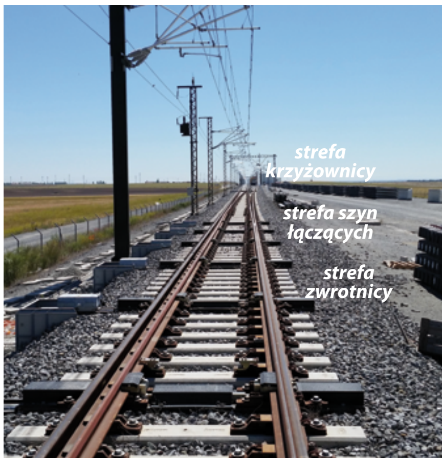
Fot. 2. Rozjazd zwyczajny na linii kolejowej dużych prędkości w Hiszpanii (fot. archiwum autora)
