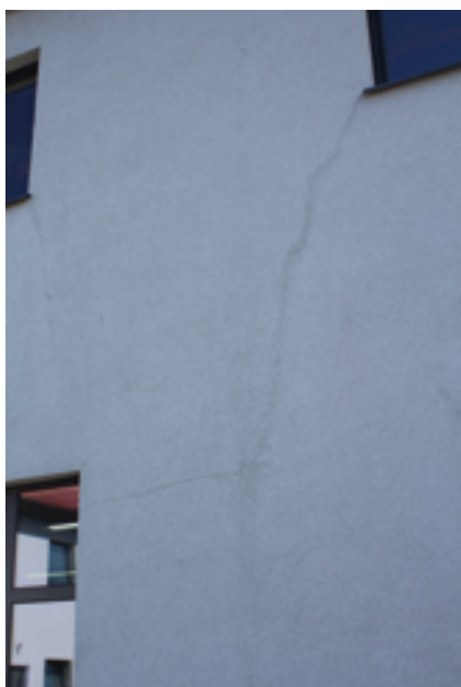
Fot. 1. Przyczyną powstania tego typu spękań może być niewłaściwe przyklejenie styropianu, a nie brak siatek diagonalnych
