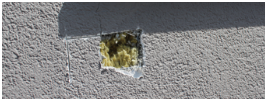
Fot. 5. Zarysowanie powstało na skutek złego przygotowania podłoża pod termoizolację
