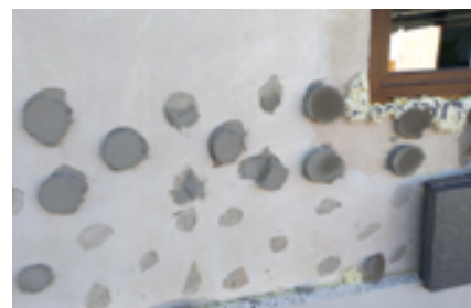
Fot. 3. Przyklejenie termoizolacji tylko „na płacki” oraz na podklejkach jest bezpośrednim przyczynkiem do jej demontażu
