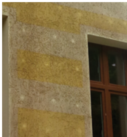
Fot. 7. „Biedronka” jest efektem niewłaściwego zakończenia termoizolacji lub stosowania niewłaściwych łączników mechanicznych
