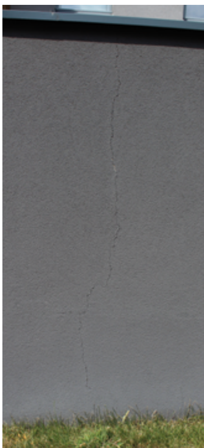
Fot. 2. Spękania ocieplonej elewacji w czarnym kolorze. Przyczyna może tkwić w zbyt niskim współczynniku odbicia światła rozproszonego – HBW
