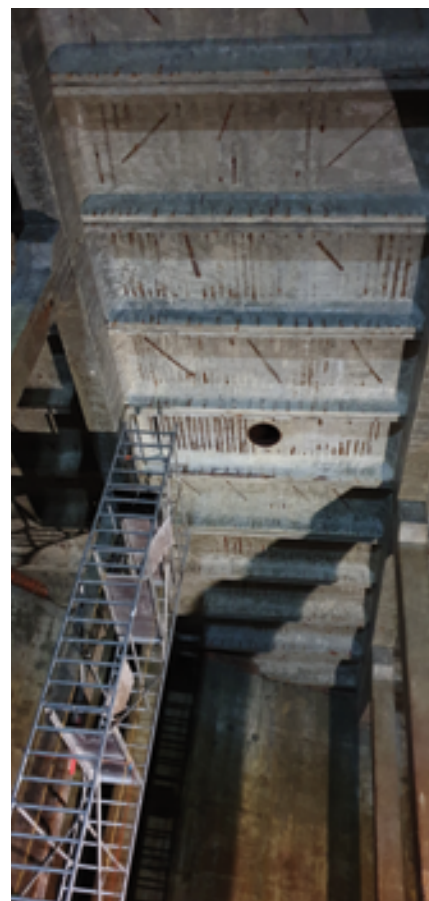
Fot. 1. Płyty korytkowe po prawie 40 latach eksploatacji
