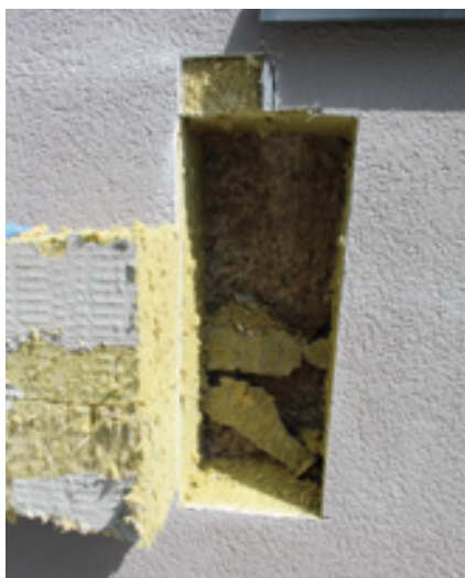
Fot. 6. Zarysowanie powstało na skutek złego przygotowania podłoża pod termoizolację
