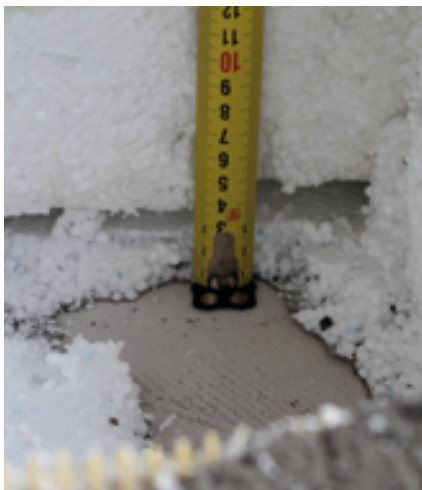
Fot. 4. Przyklejenie termoizolacji tylko „na placki” oraz na podklejkach jest bezpośrednim przyczynkiem do jej demontażu
