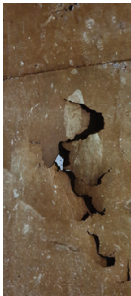
Fot. 2. Zużyta i uszkodzona powłoka żywiczna
