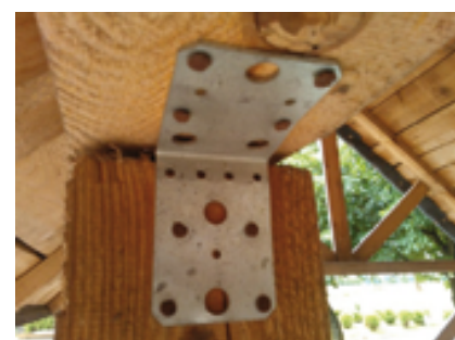
Fot. 3. Kątowniki zamontowane przy użyciu nieprawidłowych łączników
