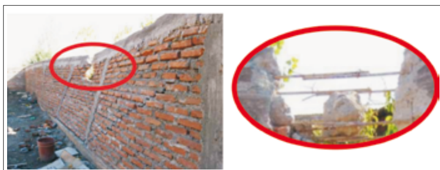
Rys. 6. Błędnie wykonane połączenie zbrojenia w połowie długości rygla [11]
