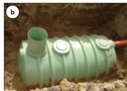
Fot. 1. Systemy kanalizacyjne: a) zbiórca sieć kanalizacyjna, b) indywidualny system kanalizacyjny – zbiornik bezodpływowy
