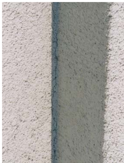
Fot. 14. Ciągła warstwa tynku, ułożona na dwóch przylegających do siebie budynkach, z pewnością prędzej czy później pęknie
