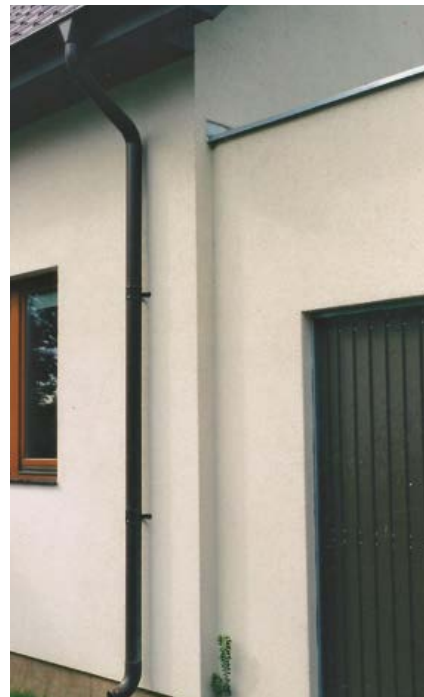
Fot. 13. W miejscu styku dwóch oddylatowanych od siebie budynków ich elewacje też powinny być od siebie oddzielone
