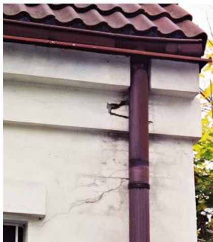
Fot. 15. Zatkane jesiennymi liśćmi ciekące rynny oraz złe obróbki blacharskie dachu dość szybko poradzą sobie nawet z najlepiej wykonaną elewacją domu
