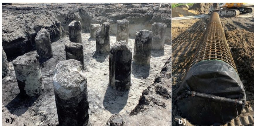
Fot. 4. Pale fundamentowe: a) część przeznaczona do skucia, b) zbrojenie pala z instalacją do iniekcji podstawy
