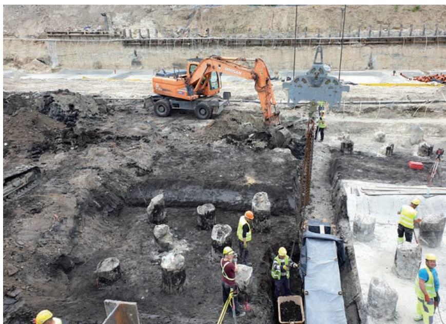
Fot. 6. Wykop fundamentowy na budowie SPSK1 w Lublinie – na pierwszym planie kolumny betonowe w gruntach organicznych, na dalszym planie podłoże piaszczyste nadające się do posadowienia bezpośredniego oraz zabezpieczenie wykopu z zestawem igłofiltrów do obniżania wody gruntowej
