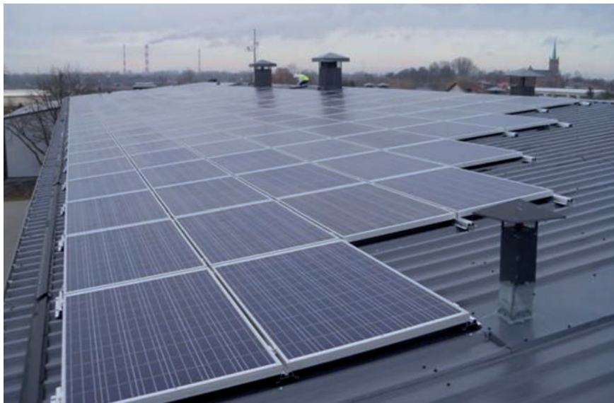
Fot. 1. Instalacja PV na dachu budynku biurowo-magazynowego (fot. M. Żydek)
