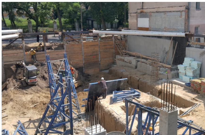
Fot. 1. Realizacja wykopu i prace fundamentowe w zwartej zabudowie, w granicy działki
