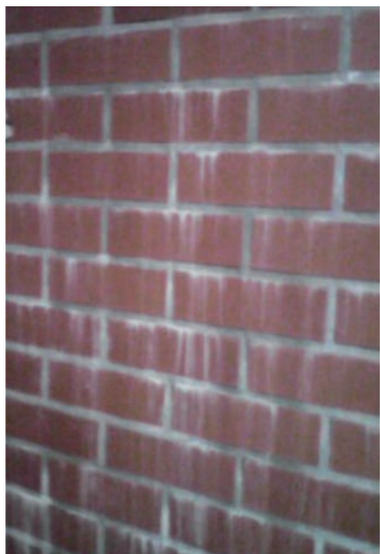
Fot. Wykwitki na zawilgoconej ścianie żelbetowej obłożonej cegłą klinkierową (fot. autor)
