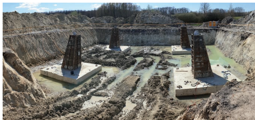
Fot. 2. Realizacja wykopu z rozkopem, bez zabezpieczenia i obniżaniem zwierciadła wody gruntowej za pomocą igłofiltrów. Po ustaniu pompowania woda ponownie napływa do wykopu
