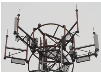
Fot. 4. Anteny telefonii komórkowej i linie radiowe na wieży
