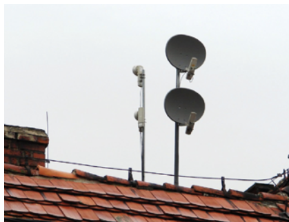
Fot. 2. System anten na wsporniku, ponad instalacją odgromową
