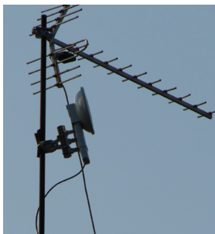
Fot. 3. Antena dostępu do Internetu, zamocowana na maszcie TV wystającym ponad instalację odgromową budynku
