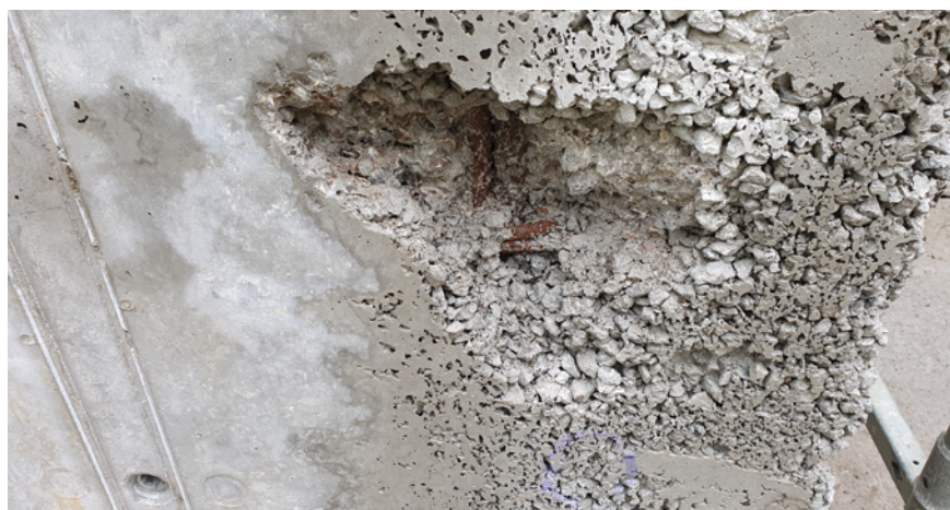
Fot. 4. Wadliwa struktura otuliny zbrojenia na skutek segregacji wbudowywanej mieszanki betonowej
