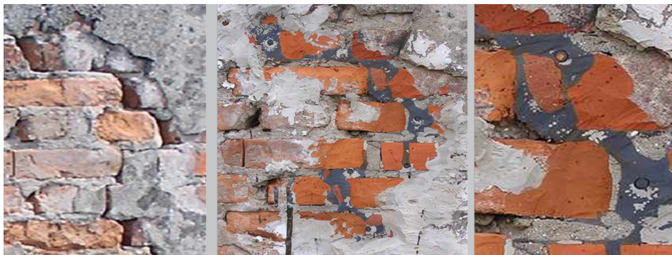
Fot. 3. Zastosowanie podatnych na odkształcenia polimerów do wzmocnienia muru ceglanego
