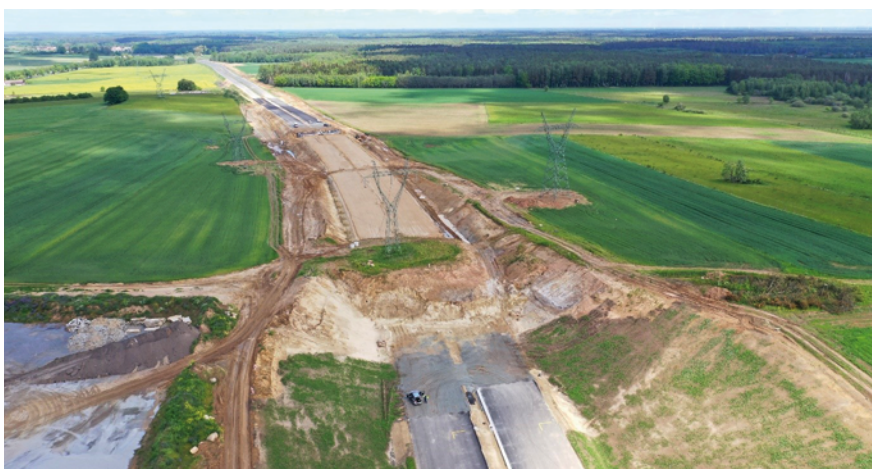
Fot. 2. Budowana droga ekspresowa kolidująca z linią 220 kV. Dla usunięcia kolizji konieczna jest przebudowa słupa
