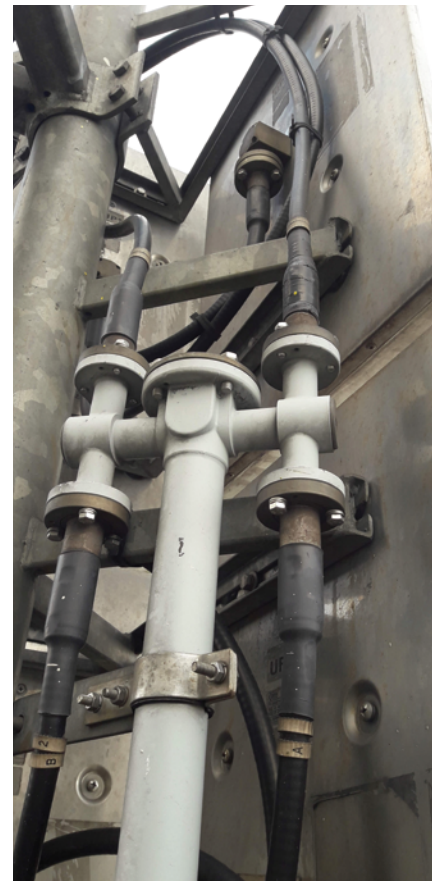
Fot. 9. Złącza, głowice, dzielniki instalacji na kominach
