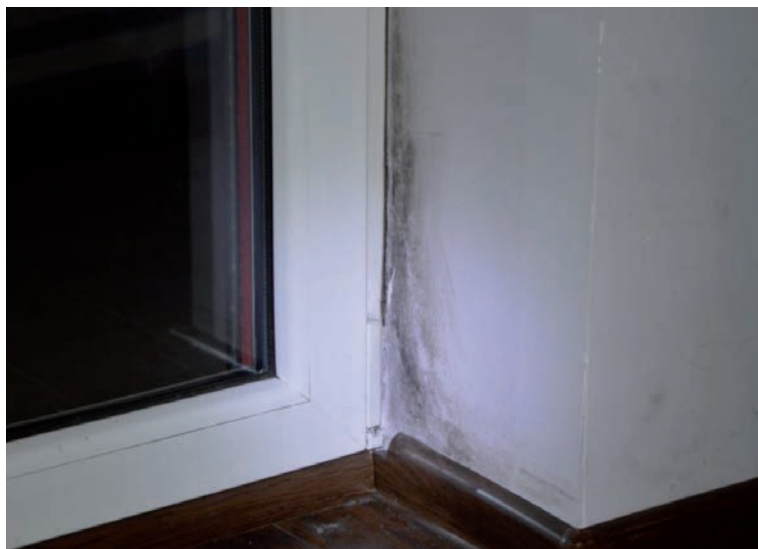
Fot. 1. Rozwój grzybów pleśniowych w miejscu mostka termicznego na styku ramy okiennej i ościeża [6]
