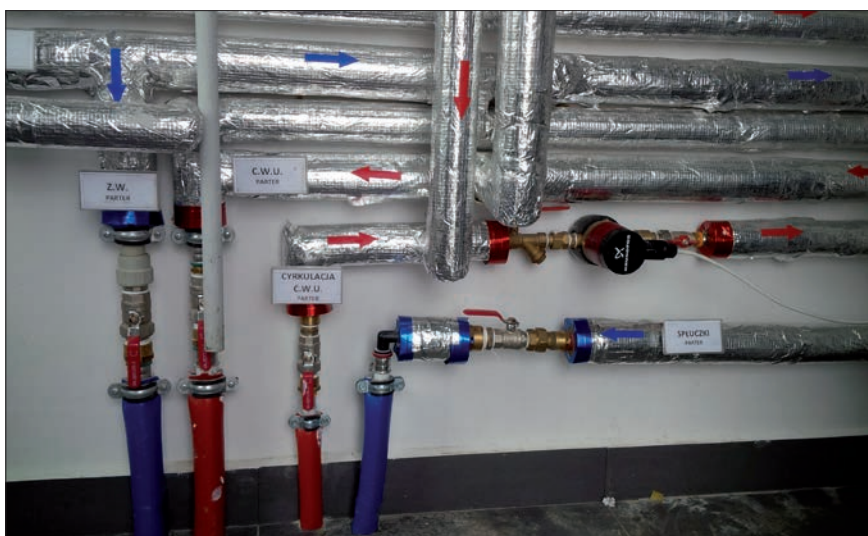
Fot. 6. Prawidłowy opis przewodów tłocznych wody deszczowej (źródło własne)
