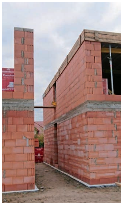
Fot. 4. Budynki „jednorodzinne” na jednej działce – w ścianach zewnętrznych (odległość w świetle muru rzędu 2 m, po dodaniu ocieplenia mniejsza) znajdują się drzwi wejściowe oraz okna
