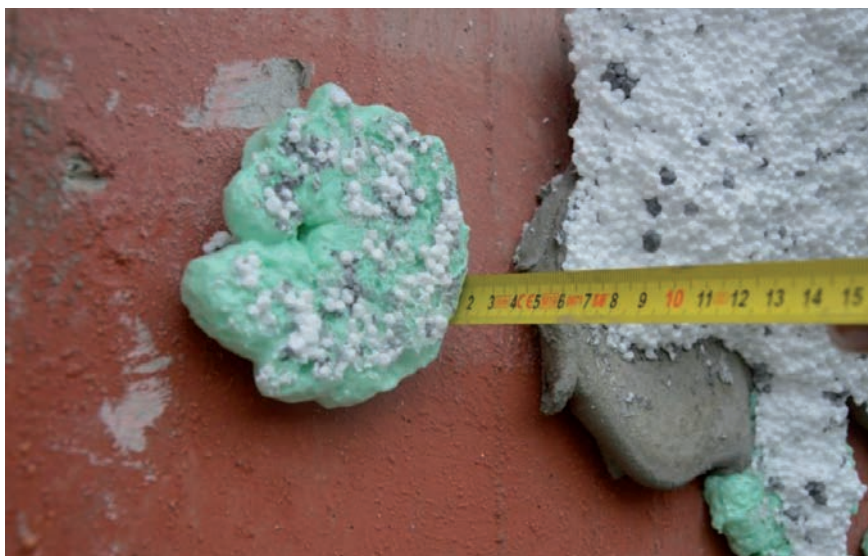
Fot. 3. Odkrywkę ocieplenia uwidaczniająca punktowo nanoszoną piankę poliuretanową i zaprawę klejącą [6]
