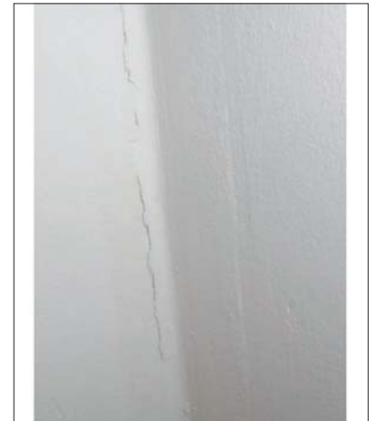
Fot. 2 | Przykład niewłaściwego wykonania szpachlowania
