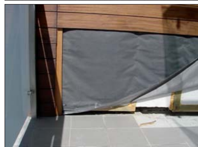
Fot. 8 | Montaż elewacji do gruntu czy posadzki balkonu naraża elewację na szybką destrukcję przez działanie śniegu i wód opadowych
