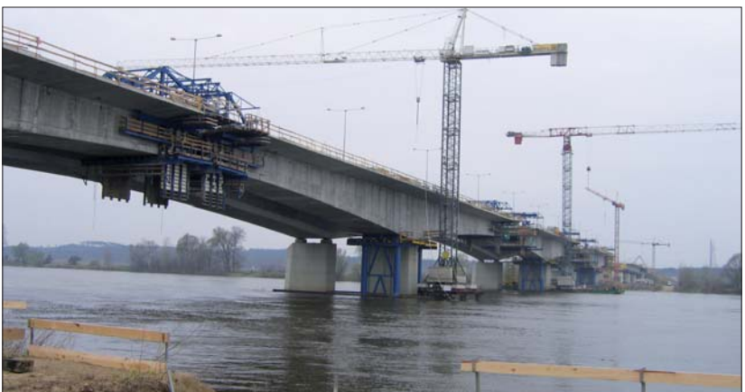
Fot. 3 | Most drogowy przez Wisłę w ciągu budowanej autostrady A1, odcinek od Nowych Marz do Czerniewic pod Toruniem – płk Głapiak nadzorował jako inspektor dobudowanie obecnie oddanej części mostu autostradowego i gruntowny remont jezdni pierwszej
