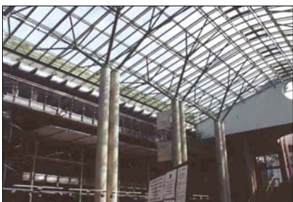
Fot. 28. Podpory wielopunktowe w bibliotece Uniwersytetu Warszawskiego
