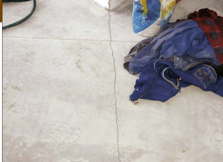
Fot. 2. Uszkodzenie posadzki przemysłowej w czasie budowy w postaci wyraźnej rysy. Posadzkę betonowano przy wysokich temperaturach w lipcu 2006. Obecnie wykonawca przygotowuje naprawę płyty przed ułożeniem warstwy żywiczej
