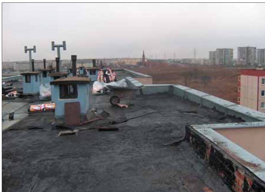
Fot. 4. Pracownik zrywający papę z tego dachu spadł i poniósł śmierć (fot. I. Skutkiewicz, starszy inspektor OIP)
