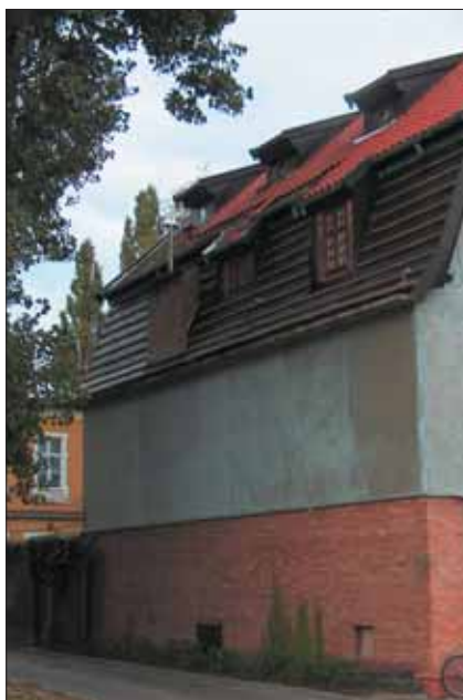
Fot. 3. Podczas remontu dachu tego budynku zginął człowiek – wypadł z okienka, z którego wchodziło na dach; nie miał zabezpieczeń osobistych (fot. I. Skutkiewicz, starszy inspektor OIP)
