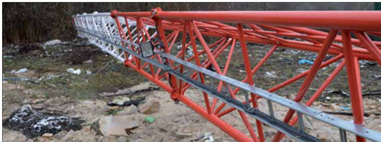
Fot. 1 | Dolny fragment powalonego masztu wysokości 81 m w miejscowości X
