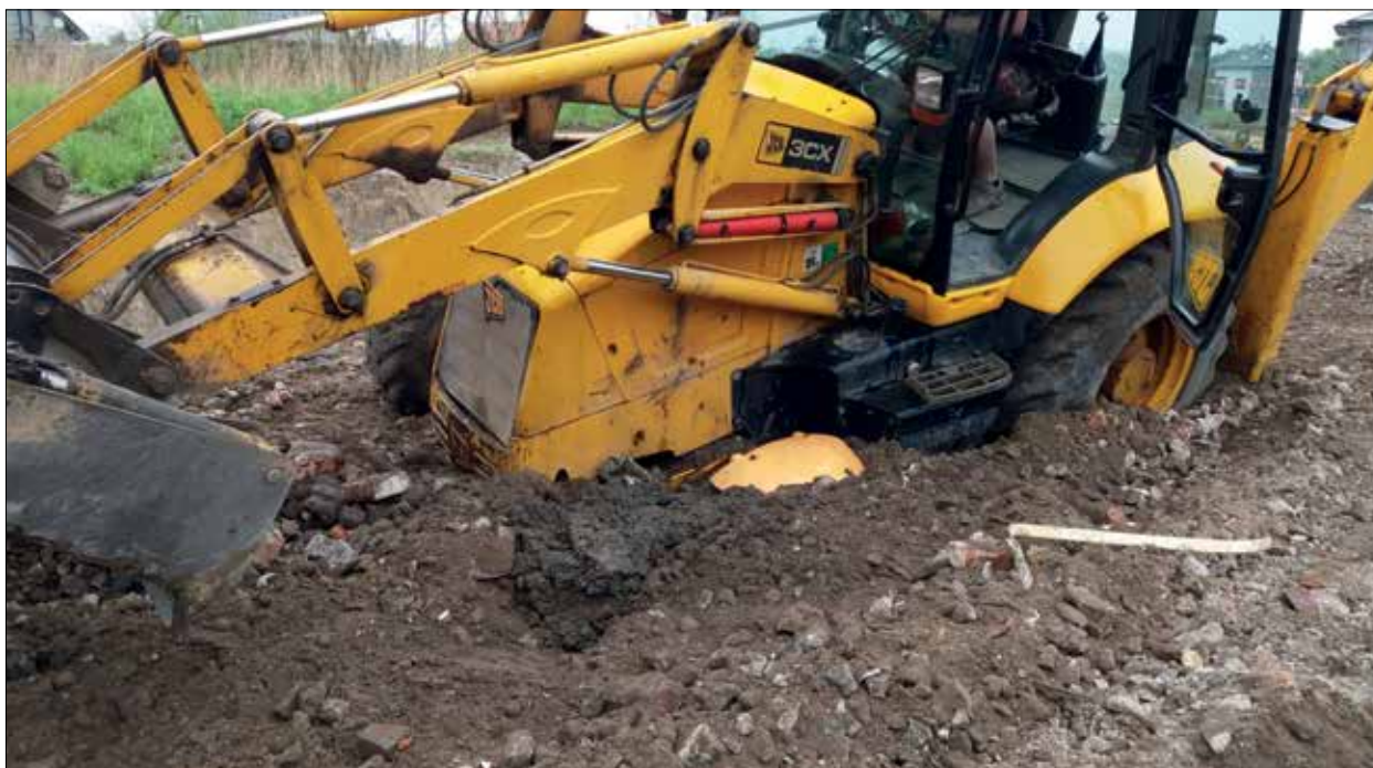
Fot. 2 | Przykład niedostatecznej nośności podłoża pod kołami koparki (fot. PZWFS)
