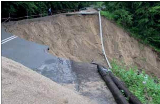
Fot. 1 Przykład osuwiska stoku z konstrukcją drogową (fot. arch. J. Siry)
