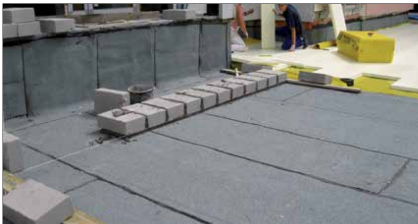
Fot. 7 | Rozwiązanie niedopuszczalne
