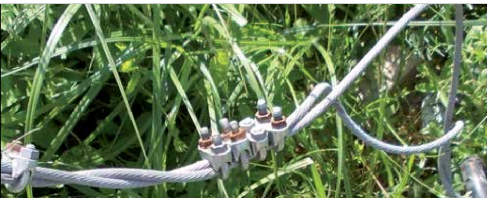
Fot. 3 | Zsunięte zaciski, lina nawet nieporysowana. Nigdzie nie znaleziono jakiegokolwiek zerwanej liny kotwiącej. To ewidentny dowód na rozkręcenie nakrętek na zaciskach przy kotwie, w miejscu gdzie był dostęp z zewnątrz, w wyniku czego maszt został położony poprzecznie do kierunku wcześniej wiejącego wiatru, w kierunku, w którym liny utraciły nośność
