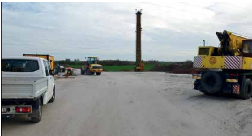
Fot. 4 | Przykład wykonanych platform roboczych i dróg dojazdowych na inwestycji prywatnej (fot. P. Rychlewski)
