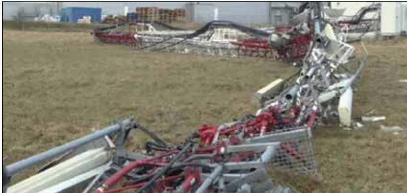
Fot. 4 | Widok masztu wysokości 60 m, który uległ katastrofie spowodowanej siłą wiatru
