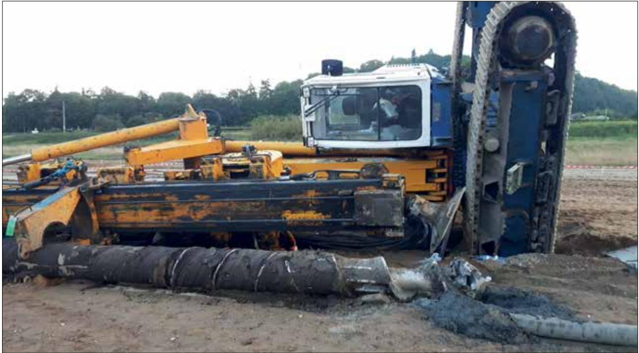
Fot. 1 | Przykład niedostatecznej nośności podłoża pod gąsienicami palownicy (fot. PZWFS)
