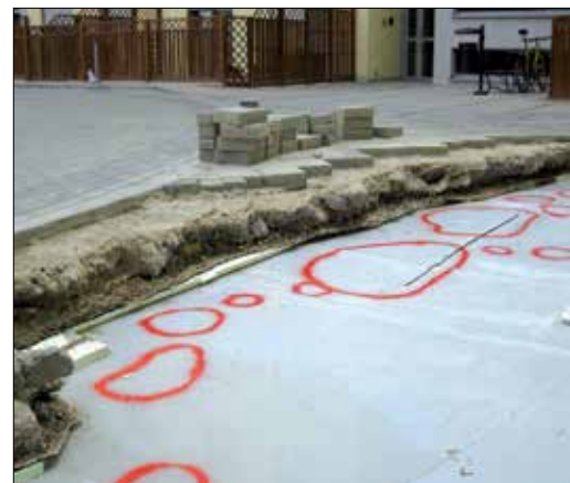
Fot. 1 | Standardowa folia PVC gr. 1,5 mm (dach użytkowy w naprawie)
