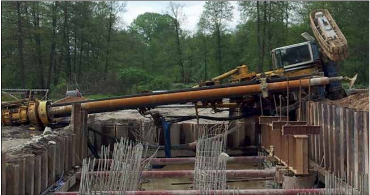
Fot. 3 | Przewrócenie palownicy poza bezpośrednie miejsce robót (fot. PZWFS)
