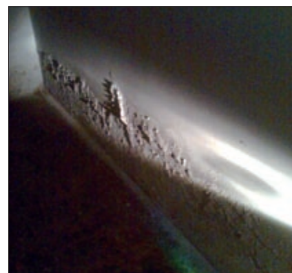
Fot. 2. Wykwity oświetlone latarką.
