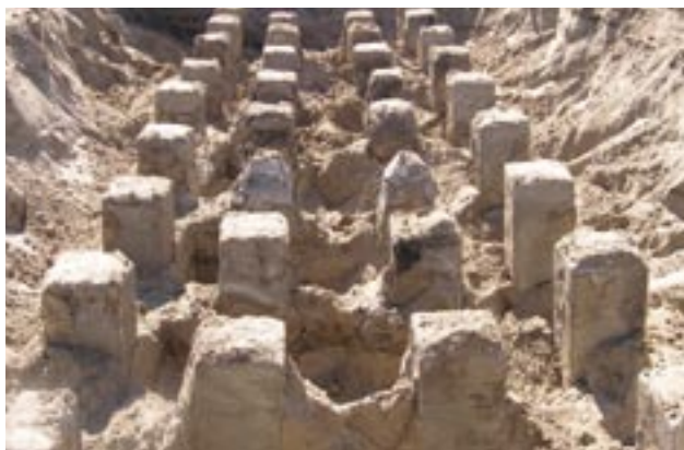
Fot. 5. Fundament palowy filara mostu M-1 przez Wartę w ciągu obwodnicy Gorzowa
