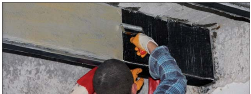
Fot. | Wklejanie mat z włókien węglowych MapeWrap C UNI-AX. Z wykorzystaniem systemu FRP (aplikacja taśm i mat z włókien węglowych) wykonane zostało wzmacnienie konstrukcji żelbetowej stropów dwóch kondygnacji budynku Wyższej Szkoły Bankowości i Zarządzania w Krakowie. Wykonanie zadania zostało poprzedzone dokładnymi obliczeniami i analizą nośności przed i po wzmacnieniu konstrukcji. Prace naprawcze prowadziła firma z Krakowa – Przedsiębiorstwo Usług Technicznych OMEGA Sp. z o.o.
