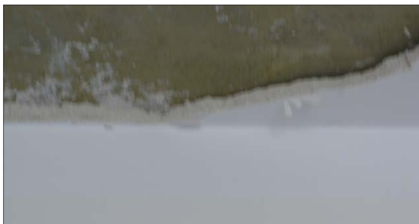
Fot. 1 | Przykład odspojenia się tynków gipsowych od nieodtłuszczonej powierzchni żelbetowego monolitycznego stropu
