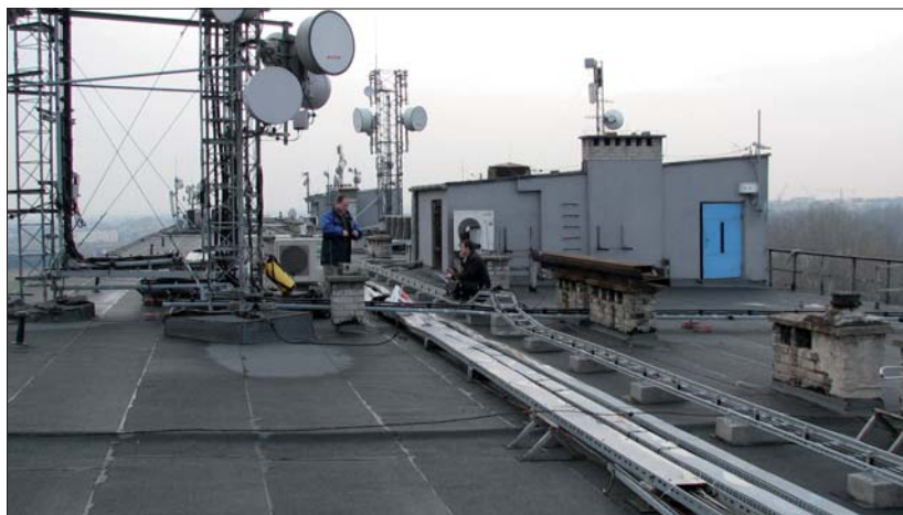
Fot. 2 | Stacja bazowa na dachu budynku w Warszawie
