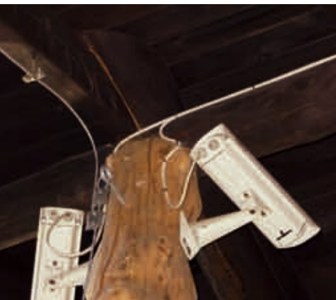
Fot.8. Brak bezpiecznego odstępu izolacyjnego pomiędzy przewodem odprowadzającym a systemem monitoringu
