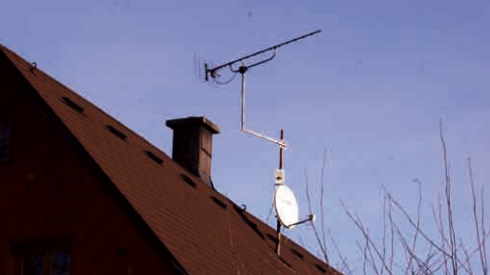
Fot. Ochrona anten na dachu budynku zgodna z zapisami normy PN-EN 62305.
