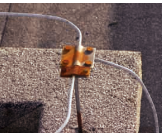
Fot. 5. Brak konserwacji instalacji odgromowej
