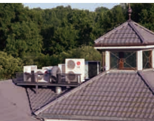
Fot. 6. Brak ochrony urządzeń na dachu obiektu
