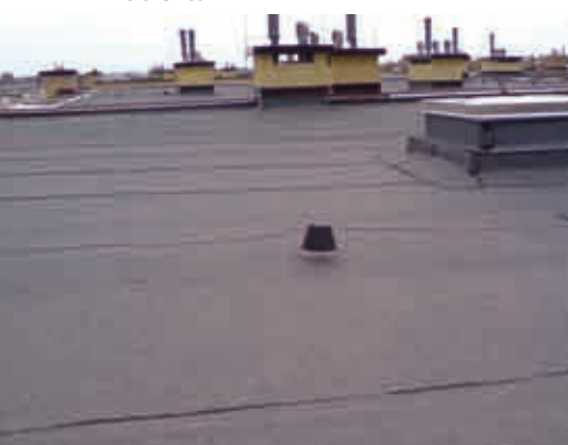
Fot. 7. Błąd montażowy – nieuwzględnienie zmian długości zwodu w skutek sezonowych zmian temperatury ( lato-zima)
