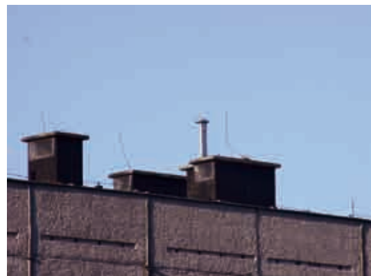
Fot. 3. Błąd montażowy – zwód pionowy niestabilny pod względem mechanicznym
