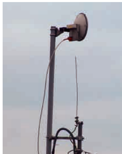
Fot. 1. Zasadniczy błąd koncepcyjno-montażowy – antena umieszczona wyżej niż zwód pionowy, który powinien ją chronić
