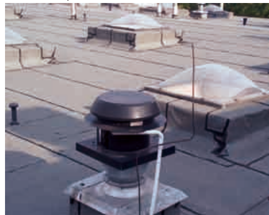
Fot. 4. Zasadniczy błąd koncepcyjno-montażowy – brak bezpiecznego odstępu izolacyjnego pomiędzy zwodem a chronionym wentylatorem
