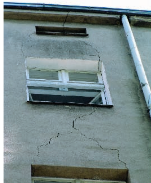
Fot. 5. Zarysowania od podwórza w części północnej budynku
