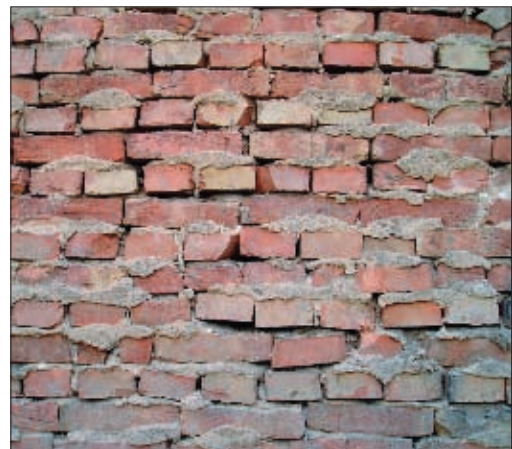
Fot. 2. Widok nieotynkowanego fragmentu ściany szczytowej
