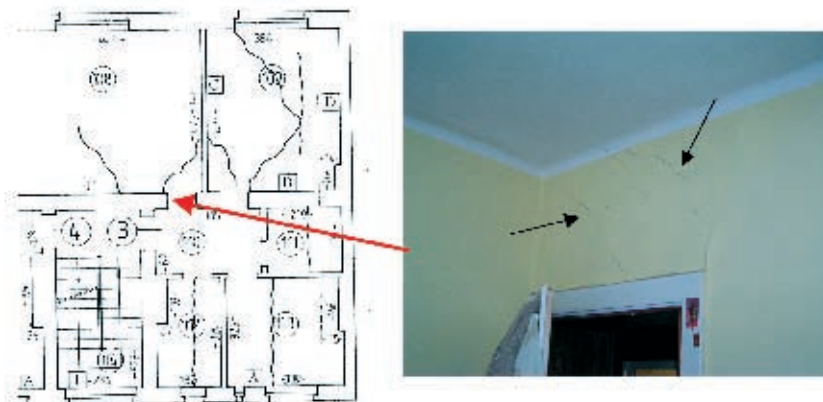
Rys. 2, fot. 3. Przykładowe zarysowania na I p. powstałe w trakcie prac w strefie sklepu na parterze
