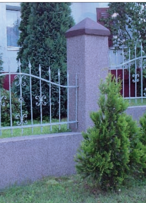
Fot. 2. Ogrodzenie ukazuje kontrowersje związane z obliczaniem wysokości. W zaprezentowanym przypadku za uzasadniony należy uznać pogląd, że przy ustalaniu wysokości ogrodzenia powinna decydować wysokość konstrukcji naziemnej, liczona na całej długości ogradzanej nieruchomości, po obu stronach ogrodzenia. Za rzetelne należy uznać górne wskazania liczone po każdej stronie oddzielnie (uzyskane pomiary będą różne).
