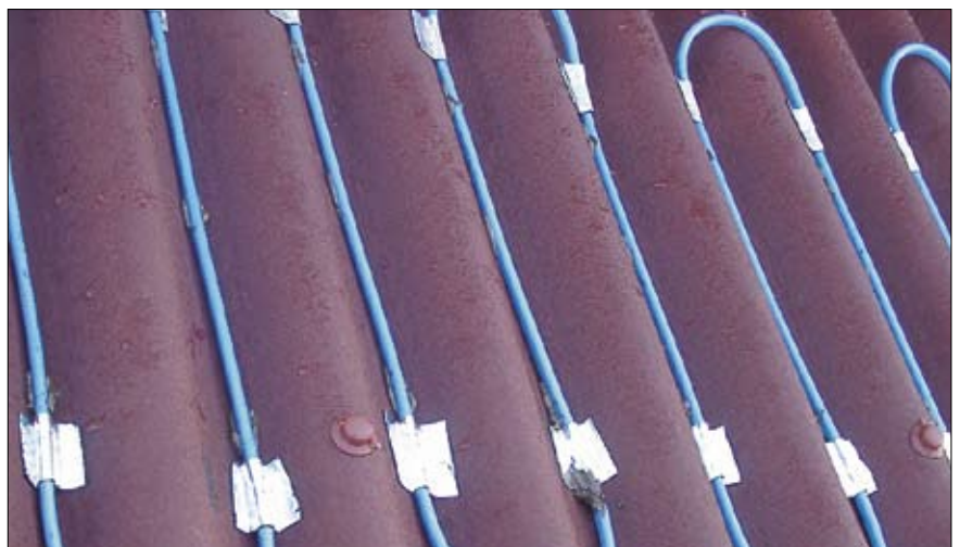
Fot. 1. Przewody na połaci dachu (fot. archiwum Elektra)
