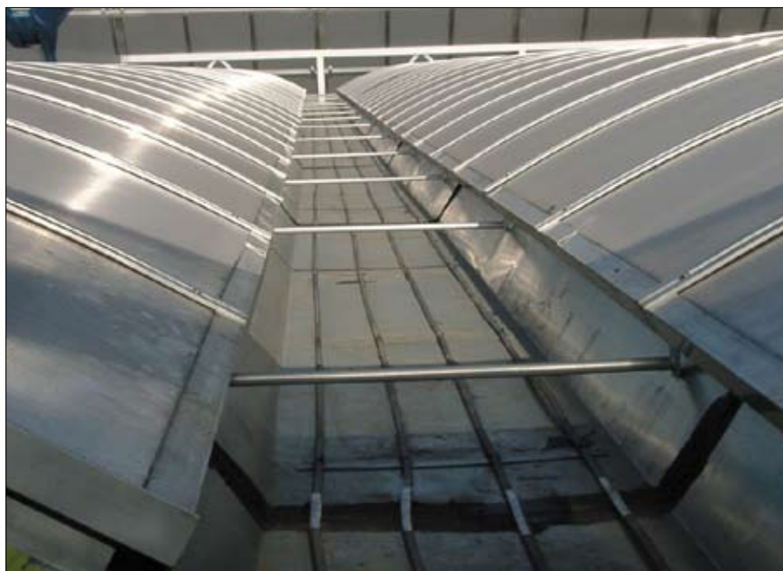
Fot. 2. Równoległe ułożone przewody grzewcze w korycie odprowadzającym wodę z dachu stadionu Wisły w Krakowie (fot. archiwum Elektra)
