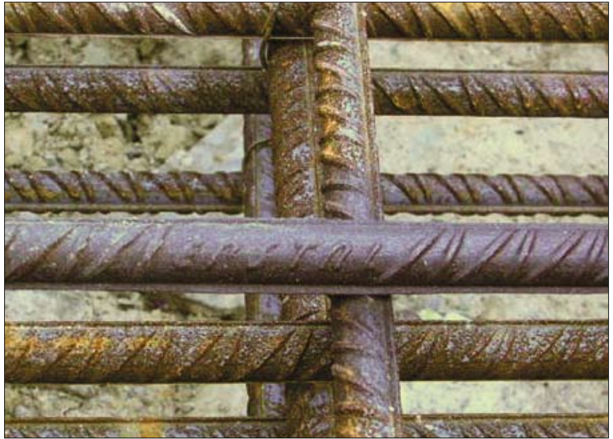
Fot. 3. Znakowanie literowe na prętach zbrojenia
