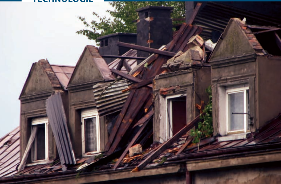
Fot. Zniszczenia po huraganie w Blachowni (woj. śląskie), źródło: www.blachownia.com
