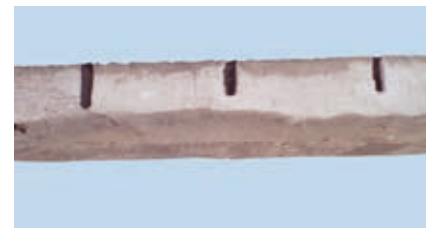
Fot. 2. Na próbce płyty fundamentowej widoczne okiem nieuzbrojonym przesunięcie substancji uszczelniających od spodu płyty w górę
