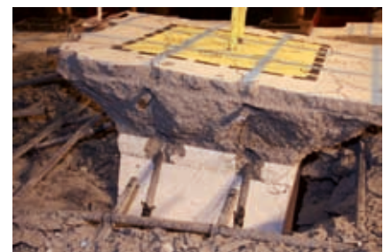
Widok zerwanych dwóch prętów zbrojenia dolnego ze stali EPSTAL.
