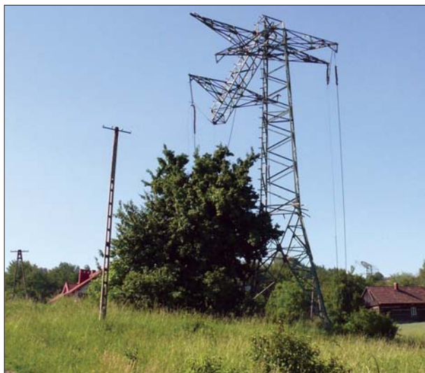
Fot. 1 | Zniszczony słup nr 34, obok zniszczona droga
