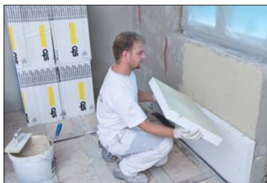
Fot. 2 Płyty systemu StoTherm In Comfort przyklejane są całopowierzchniowo do powierzchni ścian lub sufitów przy użyciu zaprawy klejowej i nie wymagają mocowania mechanicznego
