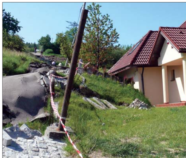
Fot. 2 | Przemieszczenia mas ziemnych w pobliżu budynku (zasypany wjazd do garażu), zniszczona droga
