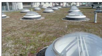
Fot. 3 | Obszar przy naświetlu nie może być przykryty zielenią EPDM, fot. autor
