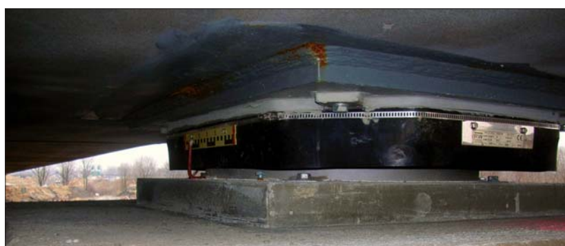
Fot. 3 | łożysko garnkowe wielokierunkowo przesuwne na podporze P80
