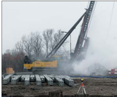
Fot. 2 | Maszyna w czasie wbijania pali ukośnych łączonych z dwóch części, przed maszyną prefabrykaty z łącznikami
