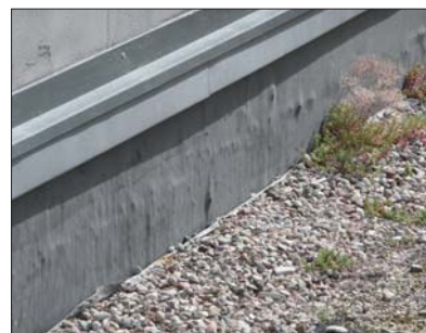
Fot. 2 | Obszar przy attyce nie może być przykryty zielenią; zdjęcie pokazuje także niedbałość wykonawcy – podłoże pod membraną EPDM musi być równe, bez kantów i wtrąceń, fot. autor
