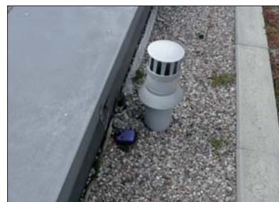
Fot. 1 | Błędne usytuowanie wywietrzaka – zbyt mała odległość od attyki uniemożliwia poprawne wykonanie uszczelnienia z membrany EPDM, fot. autor
