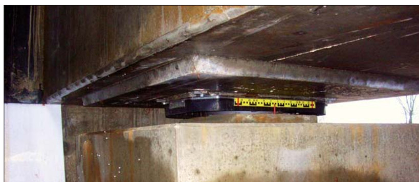
Fot. 4 | łożysko garnkowe wielokierunkowo przesuwne na podporze P110
